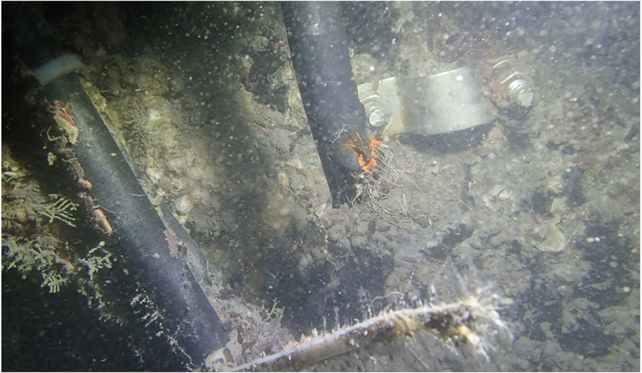
圖4.41 近岸端水下纜線受損
