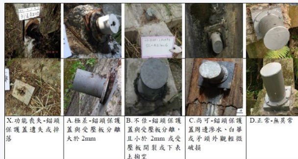
邊坡地錨檢測項目之錨頭保護蓋缺失態樣
