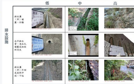
邊坡巡查項目缺失態樣
