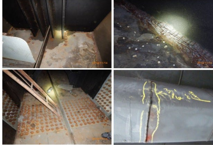
國內鋼橋箱梁內部嚴重腐蝕及裂縫案例
