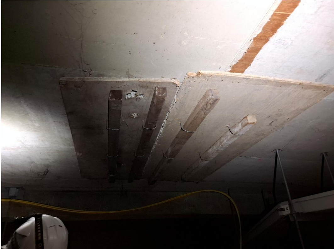
圖 4.7 箱梁內未拆除之模板
