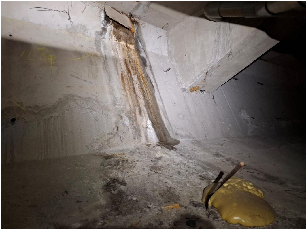
圖 4.6 滲水水痕及鋼筋突出
