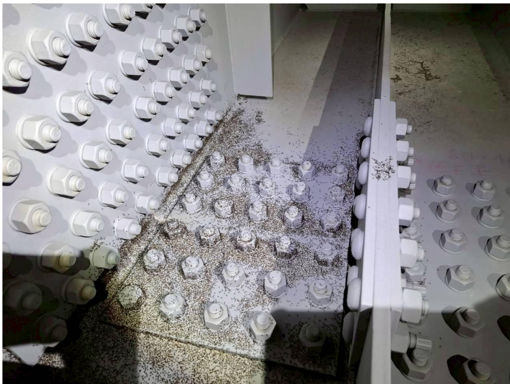
圖 4.20 鋼箱連接處有螞蟻群聚
