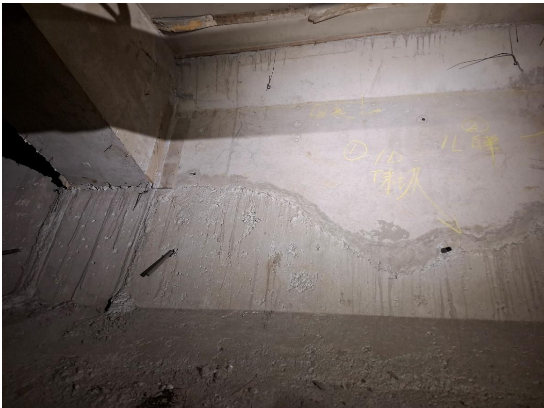
圖 4.5 壁面混凝土蜂窩現象
