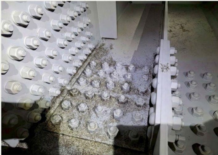
鋼箱接合處大量螞蟻群聚
