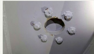
施工預留孔周圍塗裝破損生鏽
