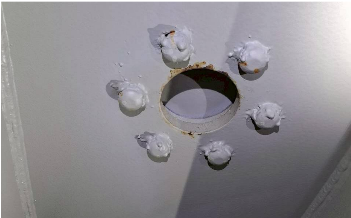
圖 4.18 施工預留孔周圍塗裝破損生鏽
