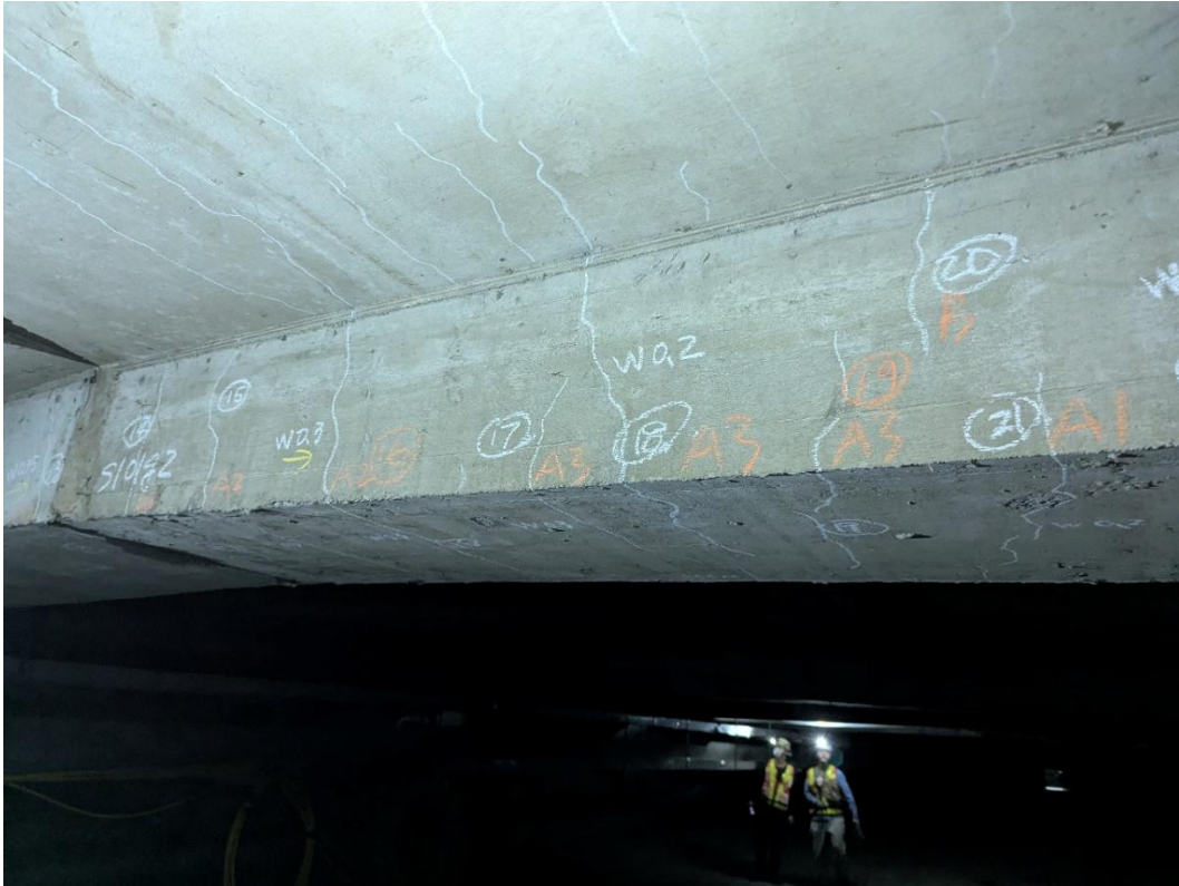
圖 4.10 橫向混凝土梁上之裂縫標記
