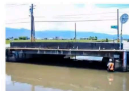
橋檢人員冒險涉水
