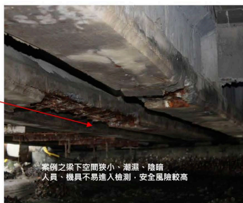
台17線臺南北門段鯤鯨橋橋梁底座鏽蝕與龜裂現象
