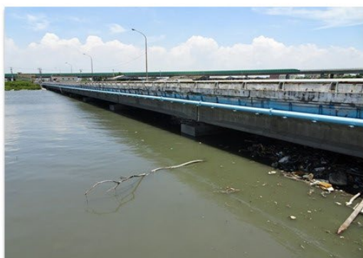
橋梁梁底近水且佈滿垃圾雜物
