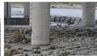
鼎型塊保護工流失情形
