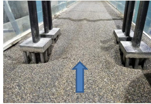
圖 2.21 無保護措施基礎冲刷情形
