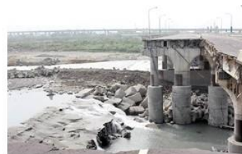
斷橋事件(橋基嚴重裸露)
