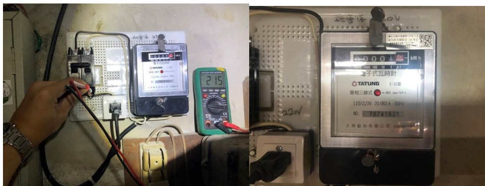
圖 6.2 安平港安裝電表及配置管線
