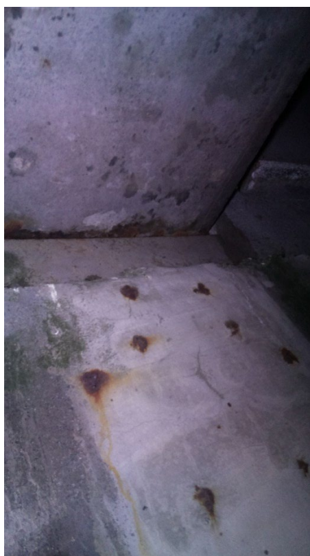
圖 5.39 大梁、支承、帽梁(鋼筋斷面生鏽)
