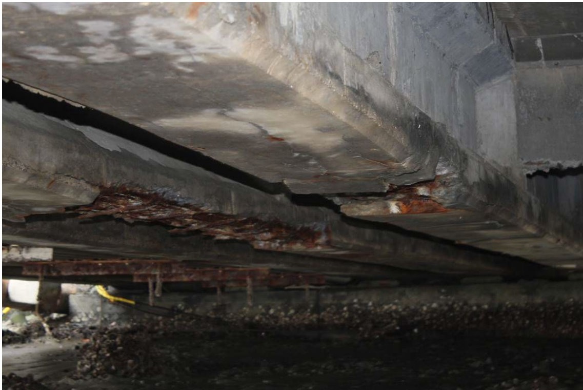
圖 1.1 台 17 線臺南北門段鯤鯨橋橋梁底座鏽蝕與龜裂現象
