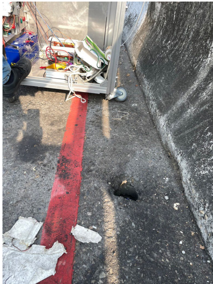
圖 5.25 設備載重輪毀損狀況
