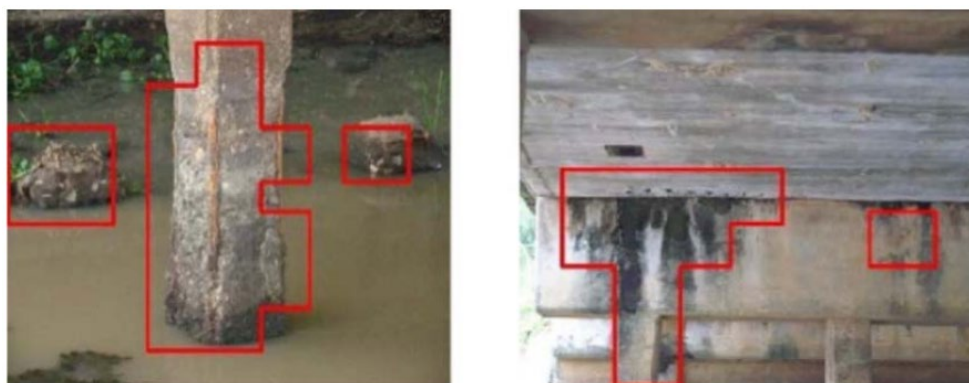
圖 2.49 鋼筋鏽蝕及混凝土污漬辨識結果
