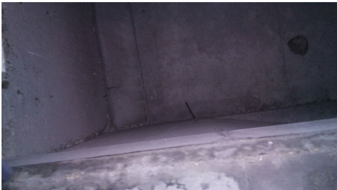
圖 5.40 鋼筋突出及表面剝落
