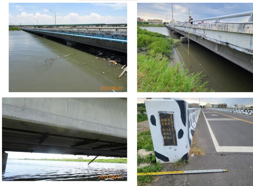
圖 5.32 第 3 次實地測試選址彰化縣福興鄉-福寶橋
