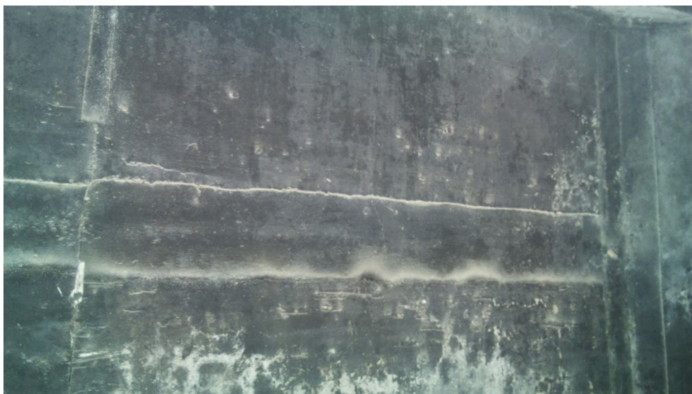
圖 5.22 第 2 次實地測試梁底影像
