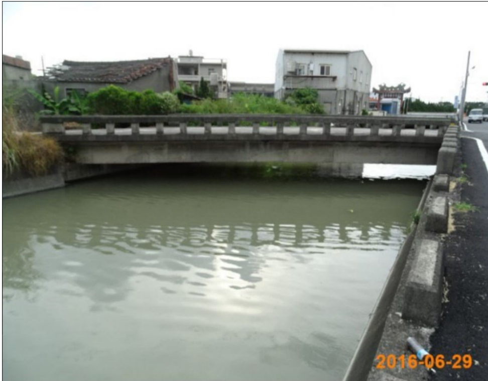
圖 2.52 梁底與河面相當接近
