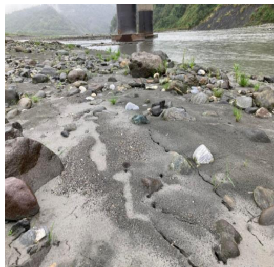
圖 2.3 2022 年 長濱地震花蓮縣玉里舊鐵橋北側，小規模液化現象 [2]
