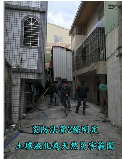
2016年美濃地震台南民宅災損
