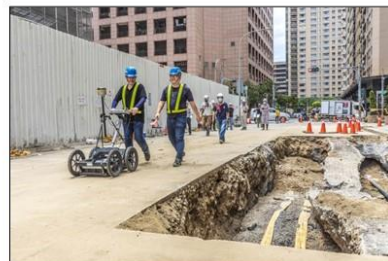
竹北工地旁道路坍塌後施作透地雷達檢測 (圖片取自中國時報/羅凌攝)
