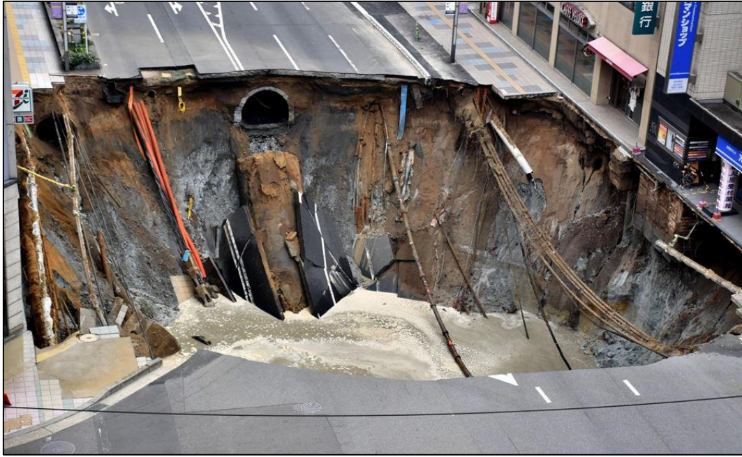
圖 4.3 2016 年日本福岡 JR 博多站前道路塌陷(圖片取自網路)
