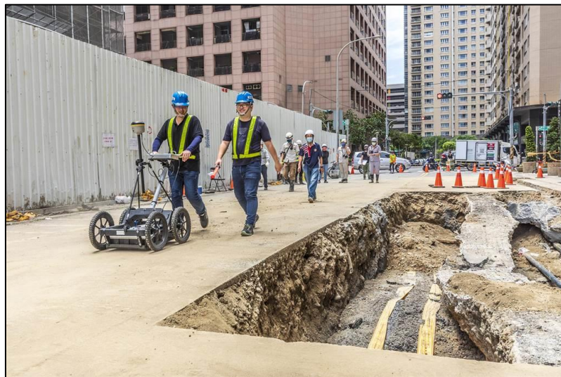
圖 4.4 新竹縣竹北市工地旁道路塌陷後施作透地雷達檢測(圖片取自中國時報)
