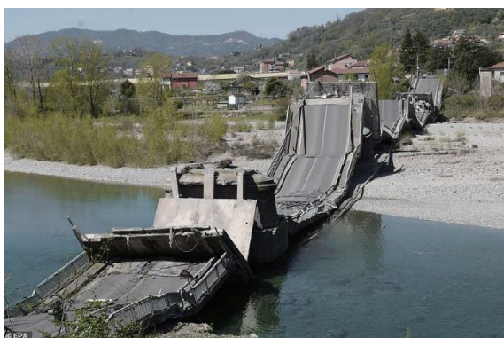
義大利奧拉橋倒塌
