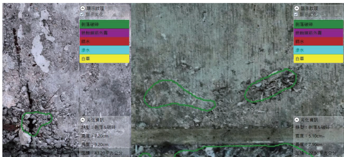
圖 4.147 混凝土剝落偵測案例
