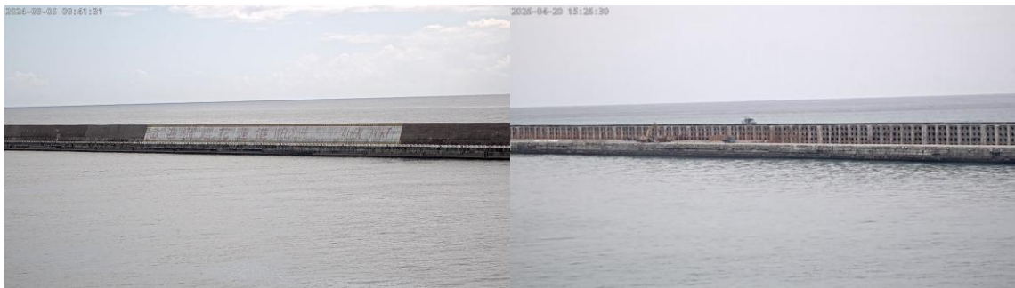
圖 8 花蓮港區東防波堤災損前(左)、災損後(右)
