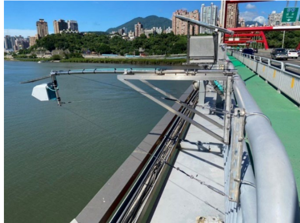
圖 4 表面流速計安裝完成之側視圖
