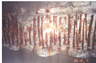
圖 2-3 腐蝕、龜裂與破裂連續循環之結果例
