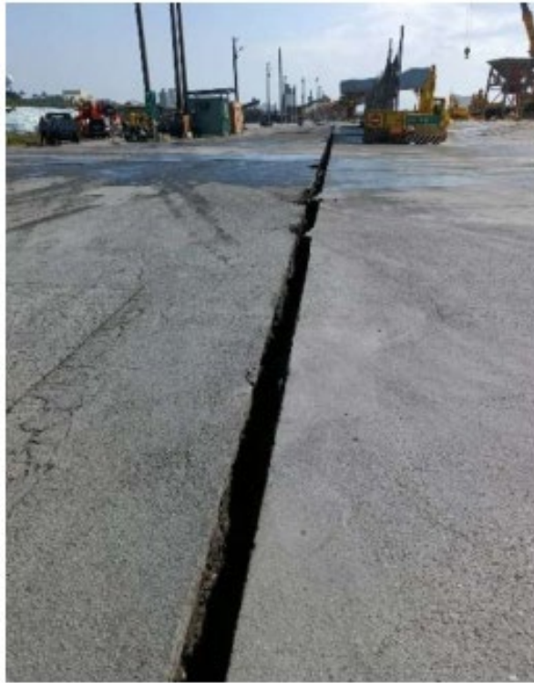
圖 14 20 號碼頭、21 號碼頭背填開裂約 5 至 15 公分
