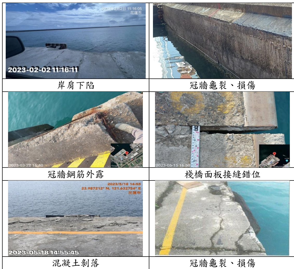
圖 3.5 碼頭法線構件項目劣化照片
