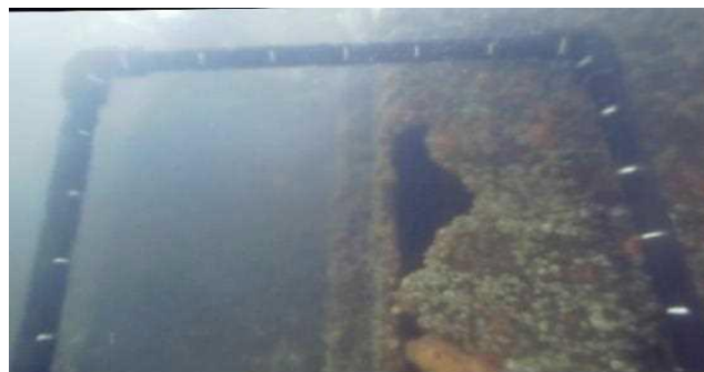
圖 4.10 鋼板樁腐蝕調查 [8]
