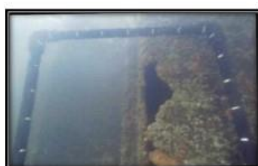
鋼板樁的腐蝕調查
