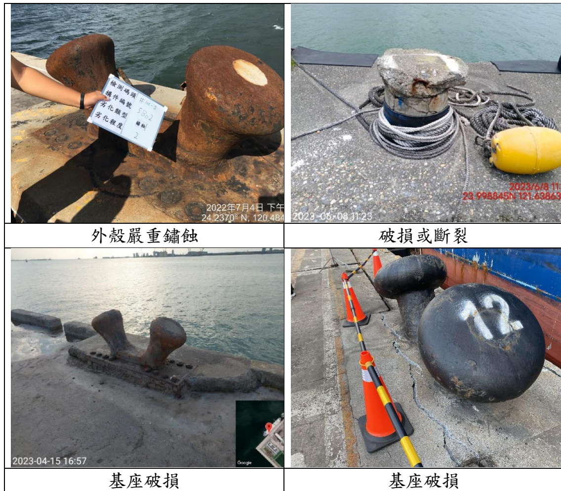
圖 3.7 繫船柱構件項目劣化照片
