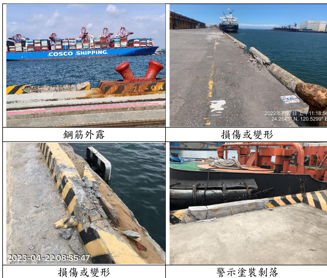
圖 3.6 車擋構件項目劣化照片
