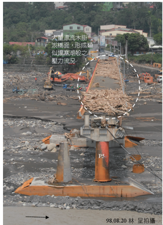
圖2 台27甲線六龜大橋於莫拉克颱風後之受災及漂流木掛淤情形
