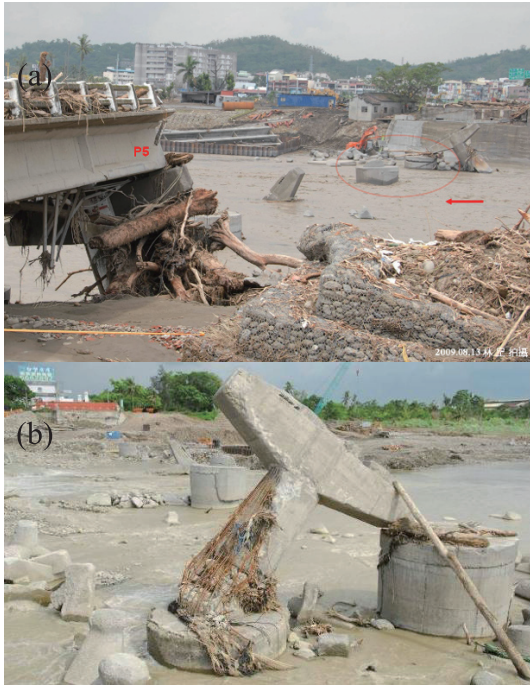
圖3 台28線旗尾橋遭漂流木掛淤、洪水沖刷及墩柱彎矩破壞之情形。
