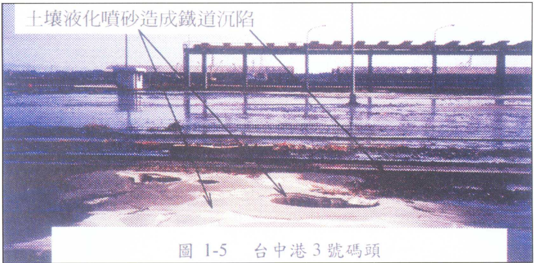
碼頭後線土壤液化噴砂地面破裂
