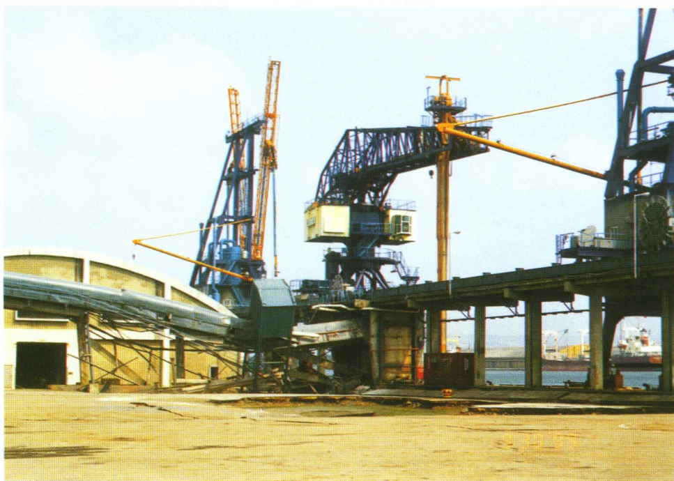
圖一 吸穀設備損壞情形
