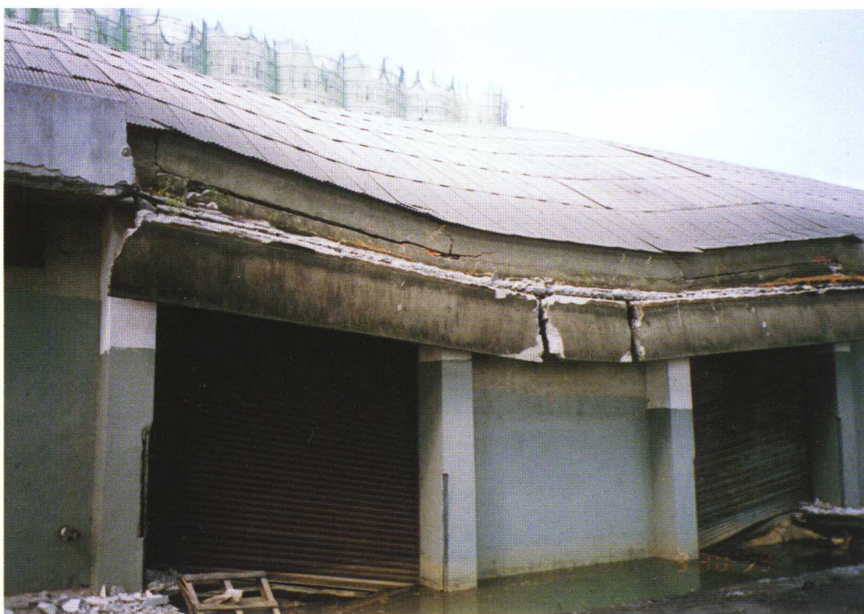
圖四 房舍受損情形
