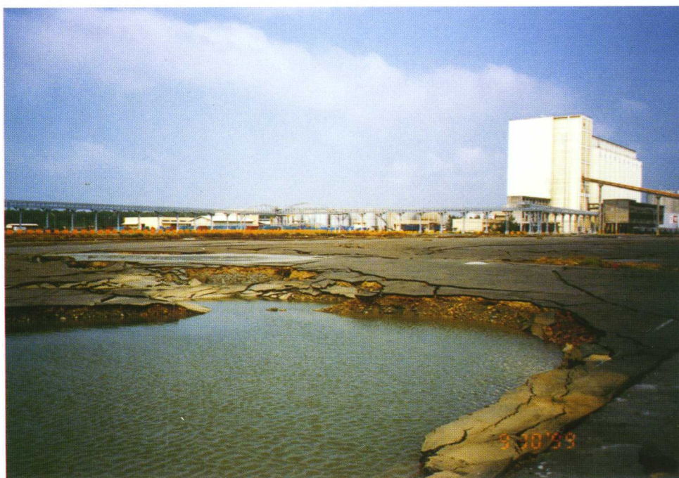
圖七 地盤陷落形成的大坑洞
