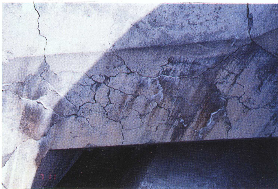
照片二 花蓮港區部份消波塊表面龜裂照片
