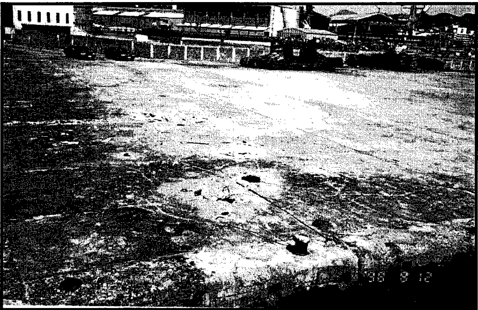
照片4 基隆港船交中心旁碼頭混凝土老舊劣化情形
