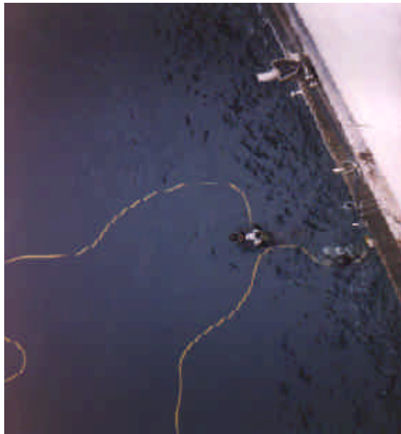
圖 1 45#沉箱胸牆安裝之波壓計
