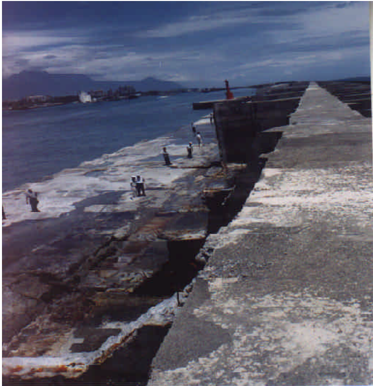
圖 5 碧利斯颱風侵襲後東堤胸牆損壞情形
