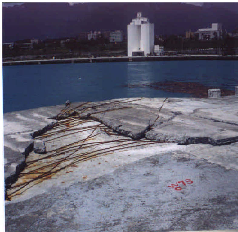
圖 8 碧利斯颱風侵襲後東堤沉箱路面損壞情形
