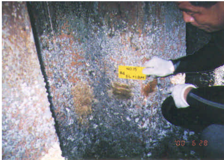
圖 16 四號碼頭大氣帶鋼板樁腐蝕現況(2)
