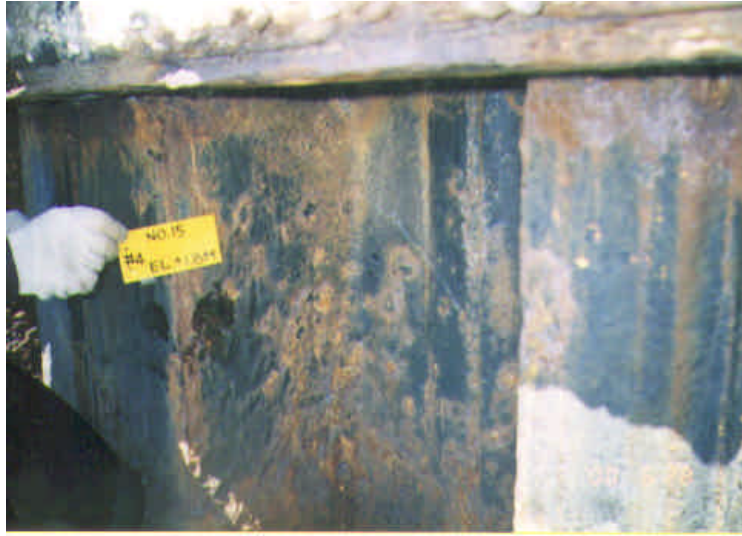
圖 15 四號碼頭大氣帶鋼板樁腐蝕現況(1)
