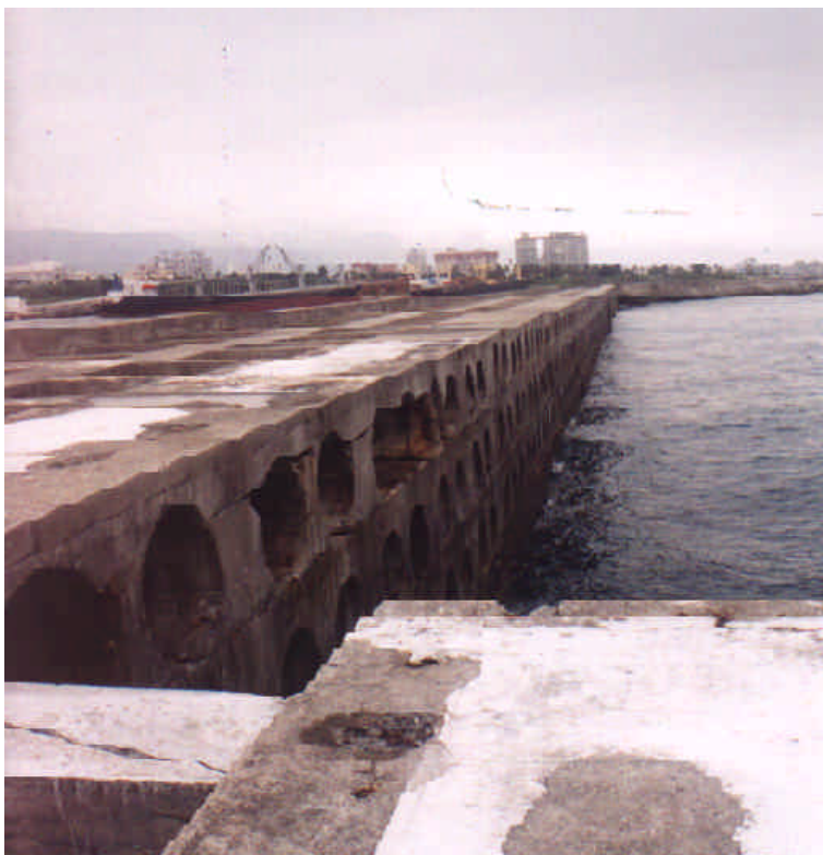
圖 6 強烈颱風碧利斯侵襲後東堤胸牆損壞情形
