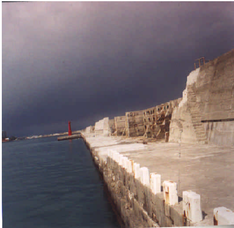
圖 7 碧利斯颱風侵襲後東堤胸牆破壞情形
