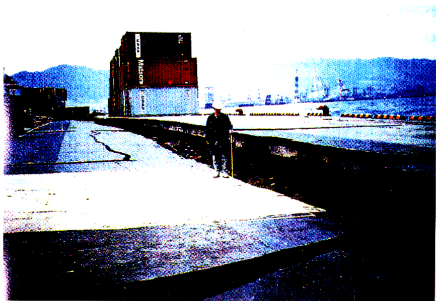
照片 1-1 1995年日本阪神烈震，Port Island南碼頭沈箱式碼頭之背填土之砂液化流失，岸肩沉陷很嚴重(約1m左右)
