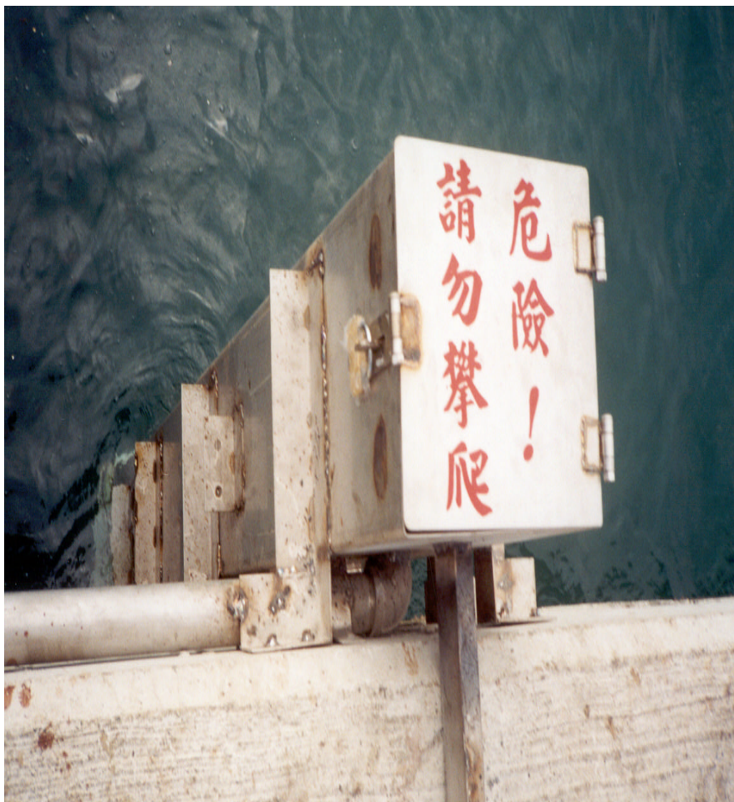
照片 1.4 鎖港防波堤堤頭設置之潮位井
