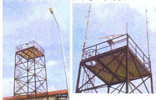
雷達天線架在室外無線電天線鐵塔上
