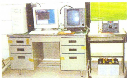
八里台北港ROCOS系統全景 (安裝於基隆港務局台北港分局工地現場)
