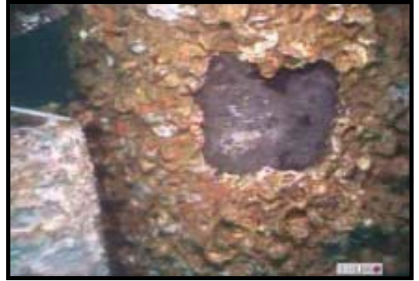
圖 3.71 防蝕區之鋼管樁表面情形
