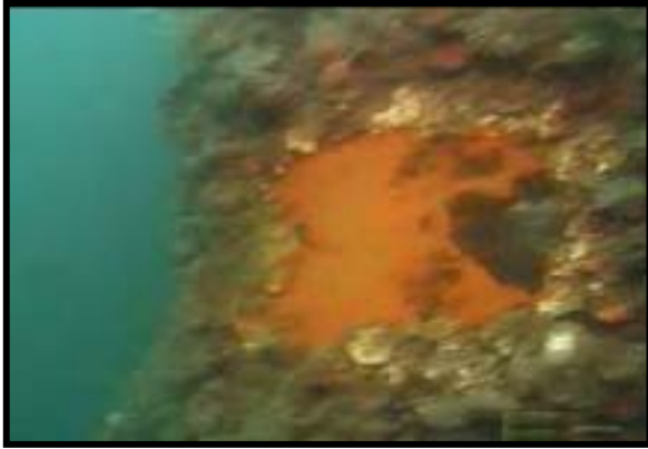
圖 3.70 未防蝕區之鋼管樁表面腐蝕情形
