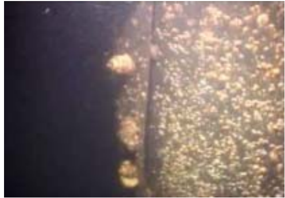
圖 3.35 潮汐帶水下保護措施固定箍鬆脫 (1)
