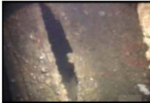
圖 3.72 舊有鋼板樁發現穿孔、破洞之情形
