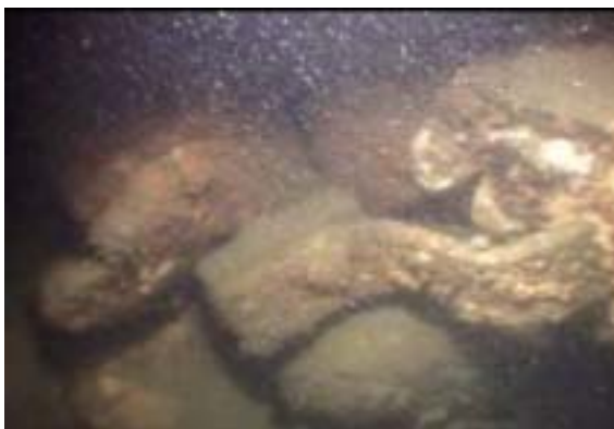
圖 3.37 海床底部陽極塊之鐵蕊鬆脫
