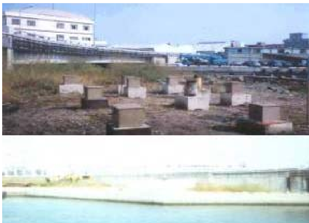
圖 16-8 安平港區地震分層監測站設置完成外貌狀況
