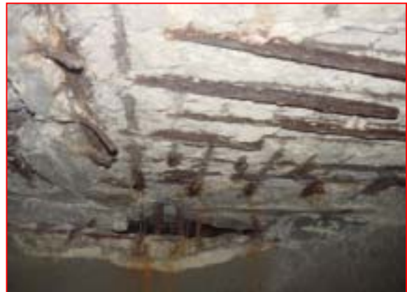
照片七 鋼筋腐蝕銹斷
