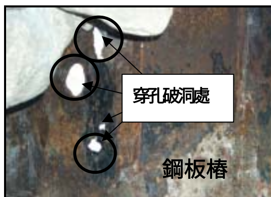
圖 11 花蓮港 5 號碼頭鋼板樁陸側 破洞之情形
