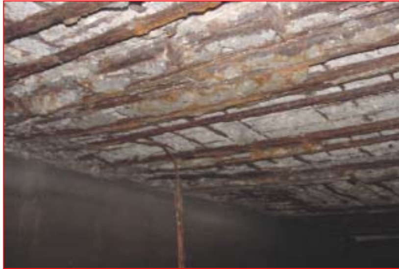
照片三 鋼筋腐蝕，混凝土剝離
