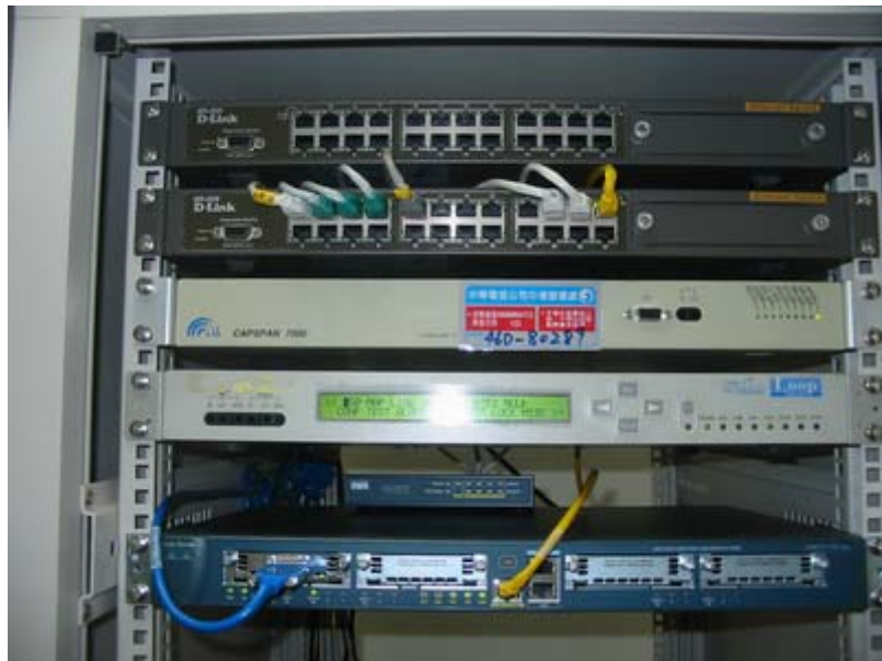
圖 23 海情中心網路設備整線後
