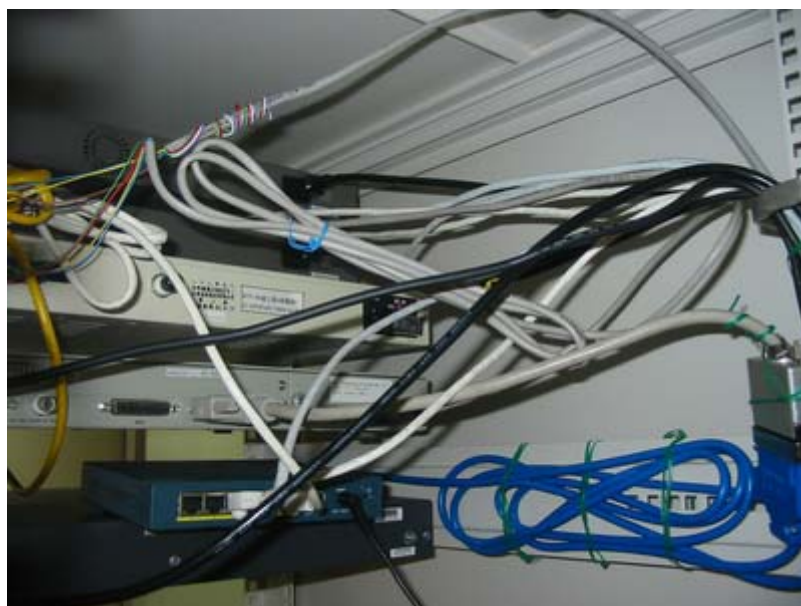
圖 25 機櫃背面線路整理
