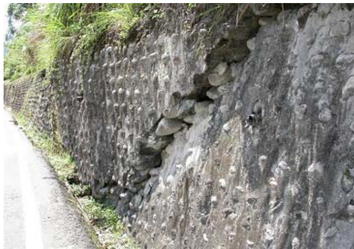
圖 7.56 牆面龜裂嚴重並有位移的情形(台 21 線 108k+780 109k+100)
