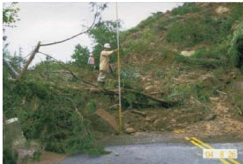
圖 7.11 台 18 線 82k+935 處艾利颱風崩塌照片
