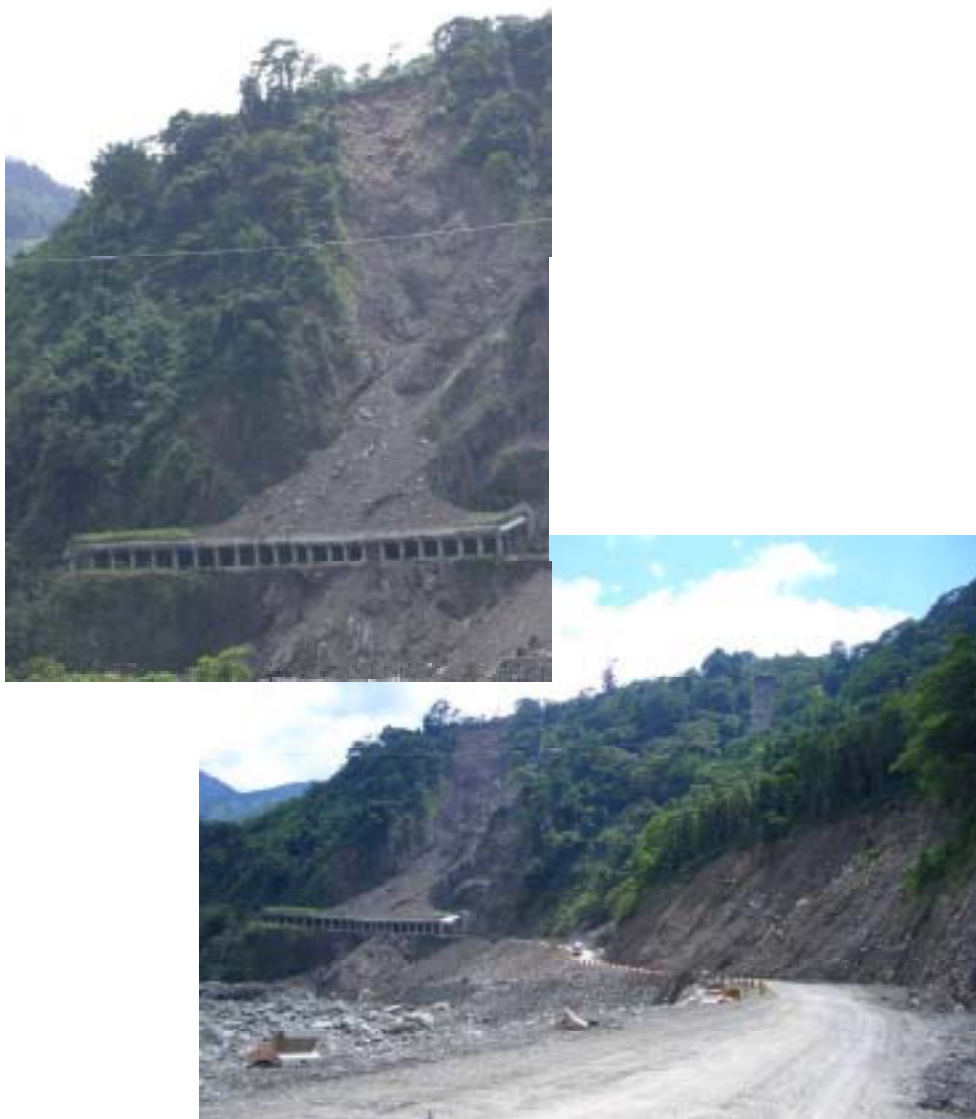
圖 7.15 台 21 線 111k+500 處邊坡照片
