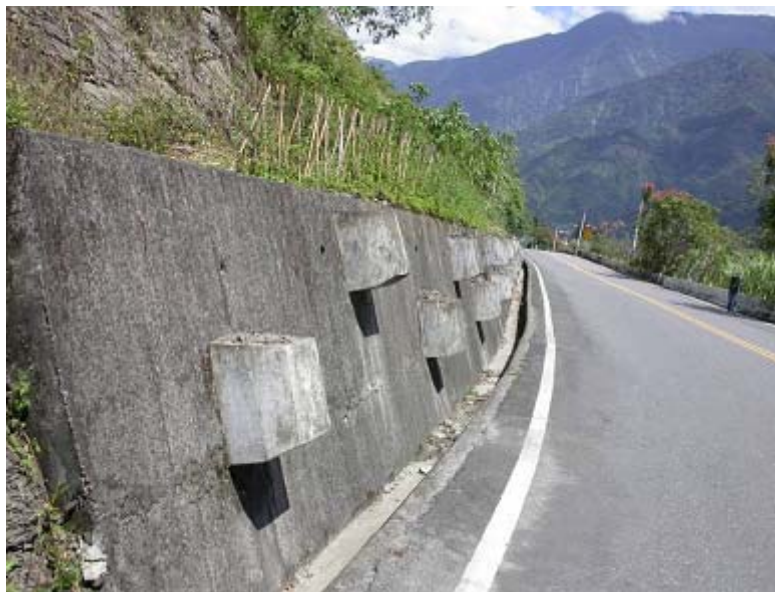
圖 7.51 錨頭處混凝土有細微裂縫 ( 台 21 線 108k+370 605 )
