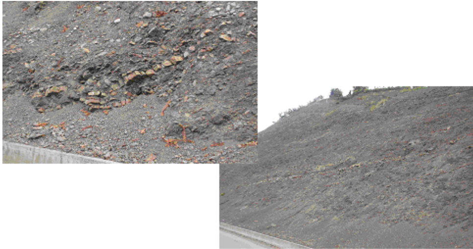
圖 7.19 台 21 線 107k+100 250 上邊坡崩落路段
