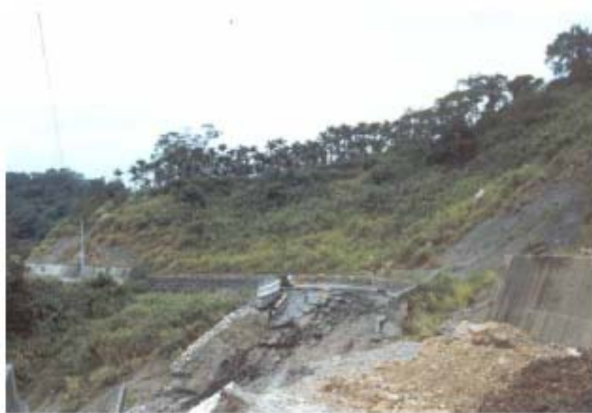
圖 6.2 道路位於斷層破碎帶而產生邊坡不穩定情形
