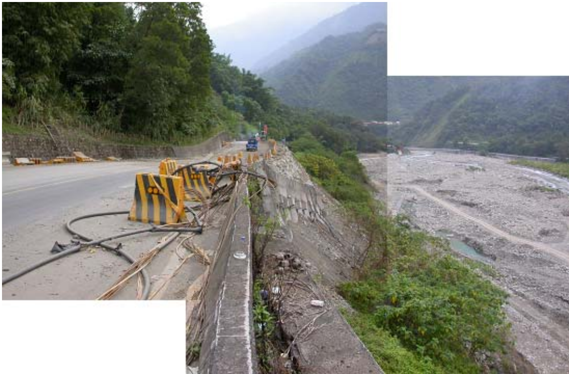
圖 7.16 台 21 線 106k+600 900 路段災損狀況
