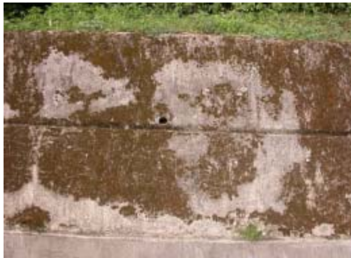
圖 7.53 擋土牆牆面混凝土輕微剝落 ( 台 21 線 129k+990 130k+040 )
