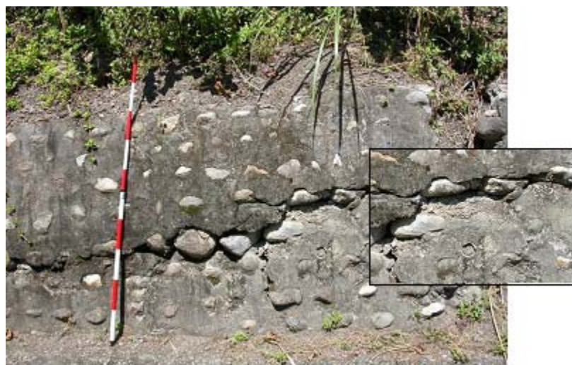
圖 7.57 牆面龜裂嚴重及排水設施堵塞（台 21 線 107k+000 035）
