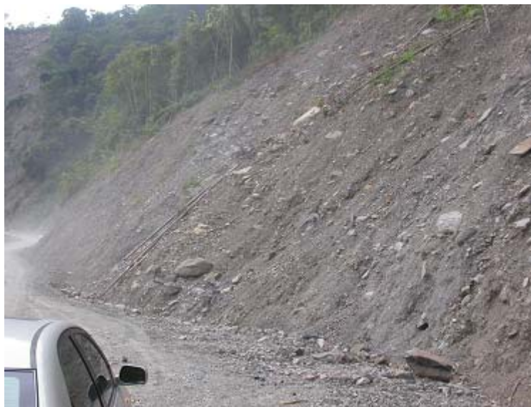
圖 7.32 崩塌區坡腳出露之崖錐堆積材料
