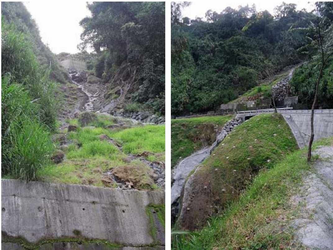
圖 7.39 溪溝上游堆積土石下移且受阻於擋土牆上方鋼軌樁
