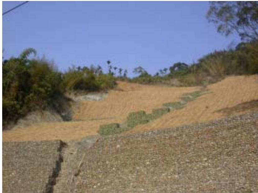
圖 4.16 台 18 線 28k+100 處上邊坡近照
