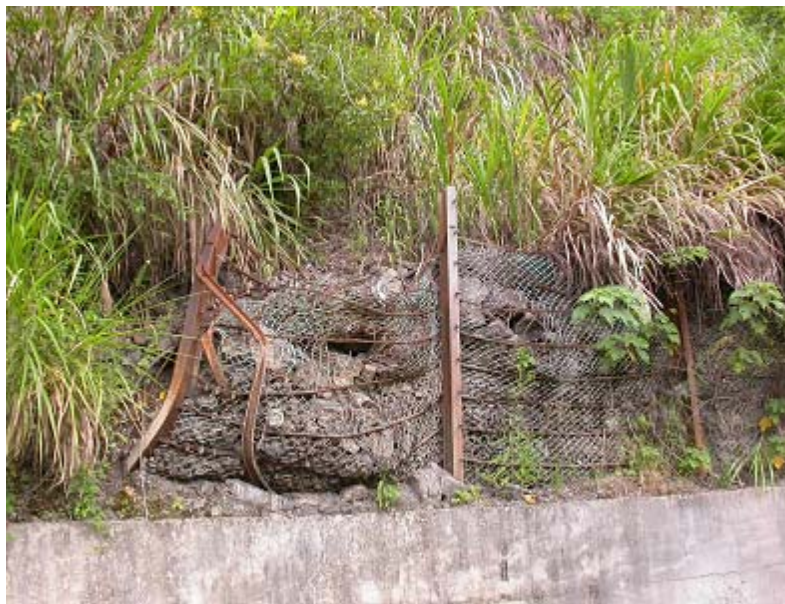
圖 7.23 台 21 線 107k+900 路段防落石柵現況
