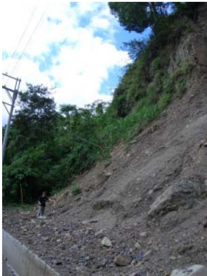
圖 7.14 台 21 線 113k+500 處邊坡裸露照片
