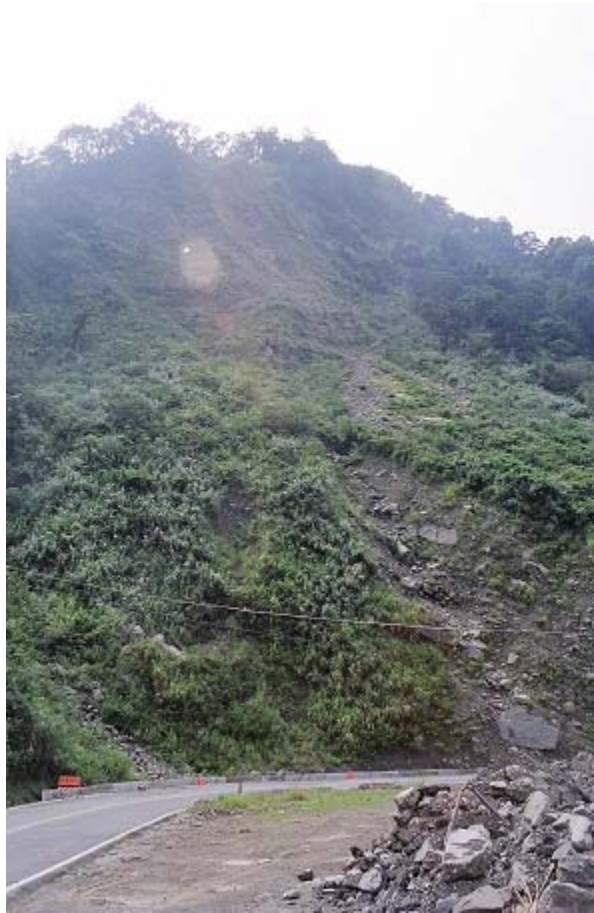
圖 7.42 118k+500 900 為向源侵蝕造成路基流失
