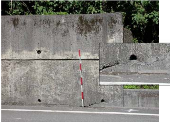
圖 7.50 擋土牆面具細微裂縫 ( 台 21 線 106k+650 838 )
