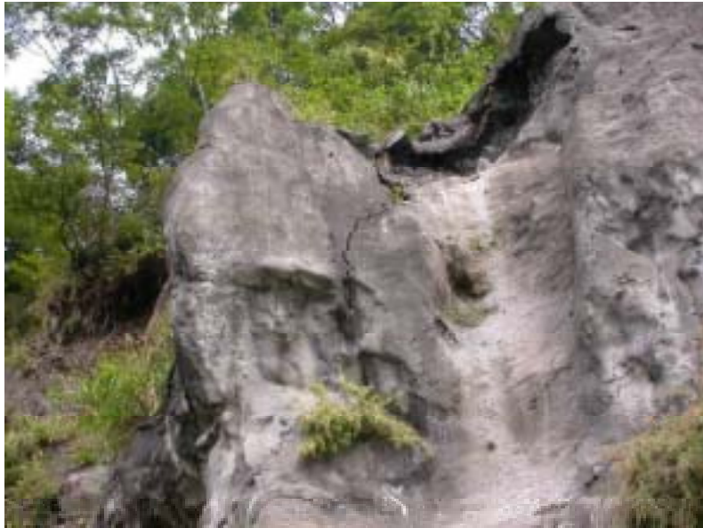
圖 7.13 台 21 線 113k+500 處邊坡裂縫照片
