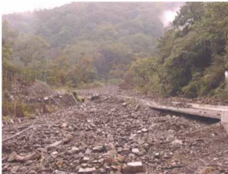
圖 6.3 野溪爆發土石流而造成道路中斷
