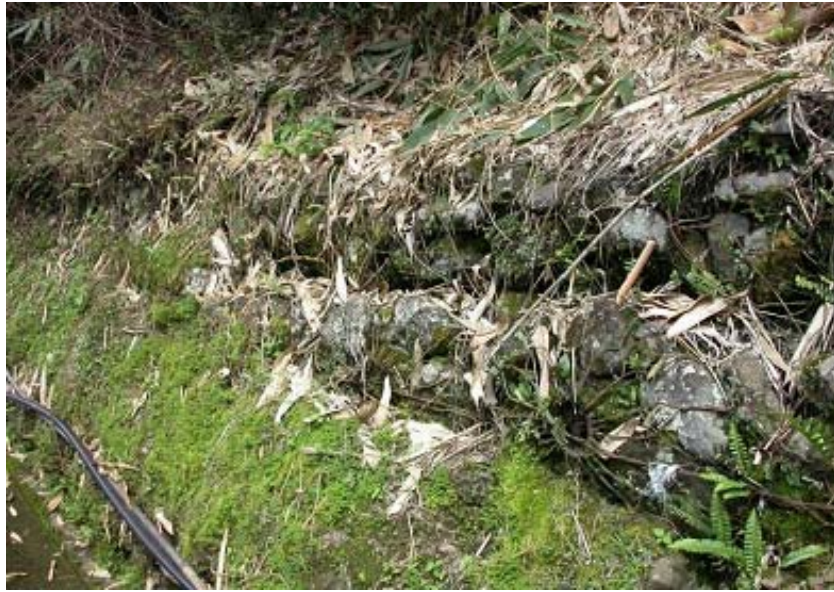
圖 7.52 牆面鋼網輕微銹蝕 ( 台 21 線 115k+840 850 )
