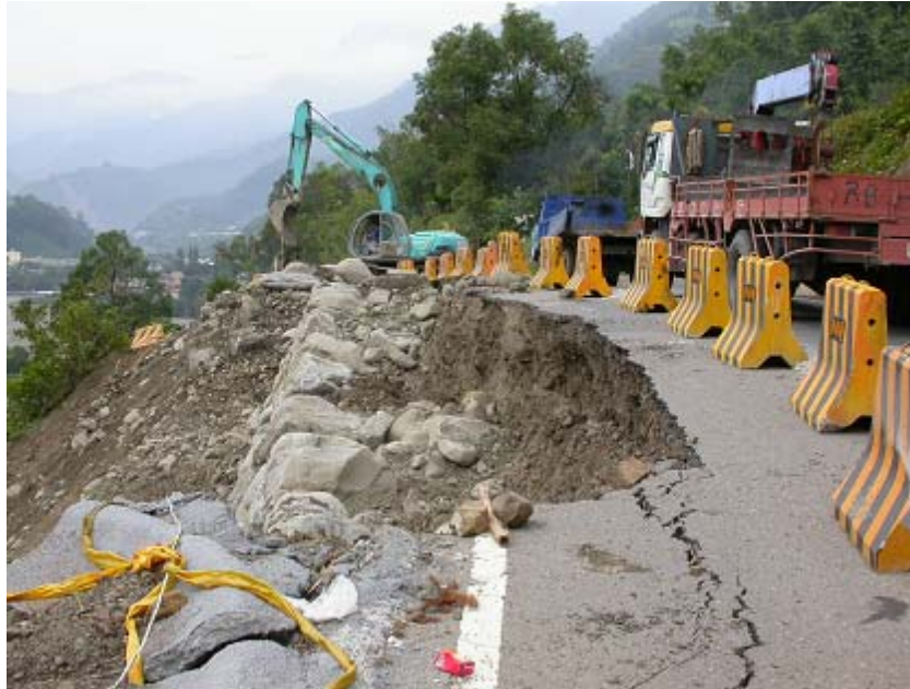
圖 7.21 台 21 線 107k+100 250 部分路基流失路段
