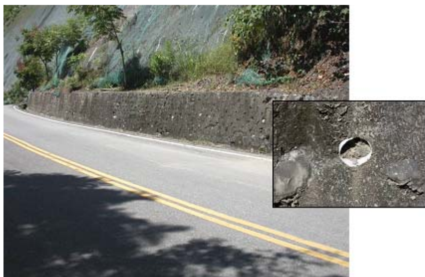
圖 7.55 牆面有排水設施部份堵塞（台 21 線 107k+650 810）
