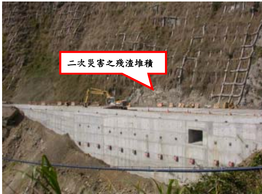
圖 4.13 台 18 線 65k+000 處上邊坡坡趾照片
