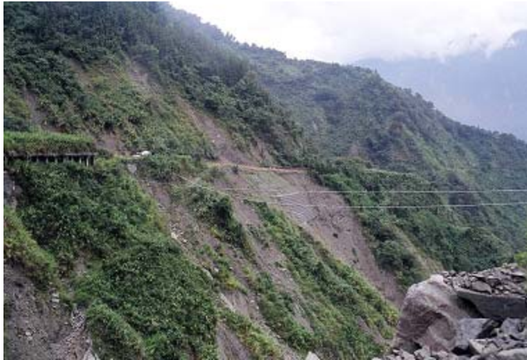
圖 7.43 126k+500~127k+440 為發生多次發生地基流失
