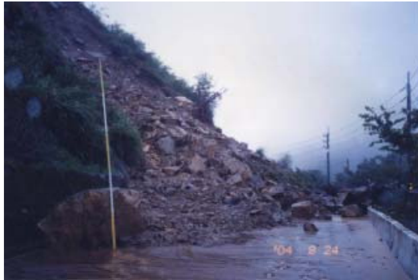
圖 7.10 台 18 線 82k+855 處艾利颱風崩塌照片
