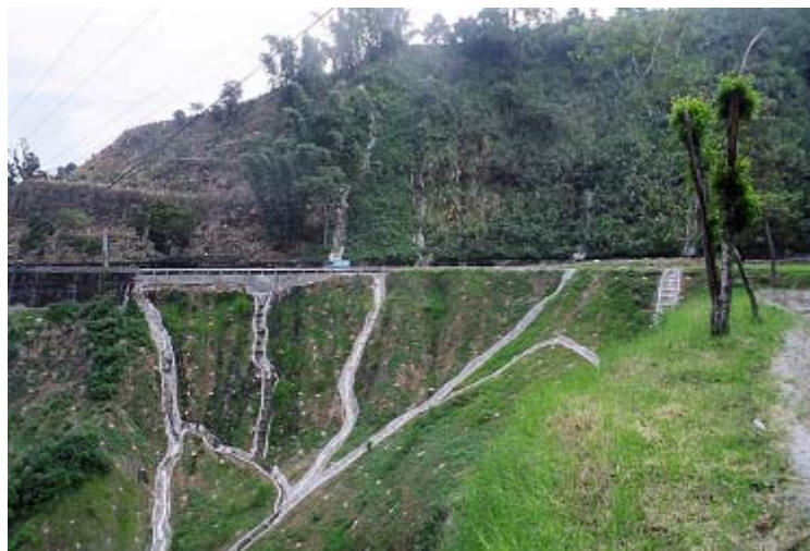
圖 7.38 敏督利颱風發生路基缺口以及土石崩落災情之復建工程
