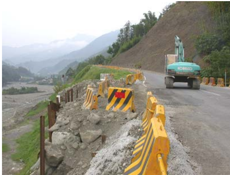
圖 7.18 台 21 線 107k+100 250 災害路段全貌
