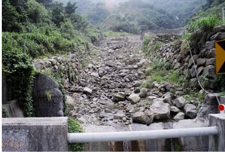
圖 7.41 頭坑橋橫上游溪床土石堆積情況
