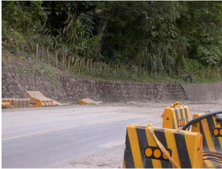
圖 7.17 台 21 線 106k+600 900 路段路面下陷等災況
