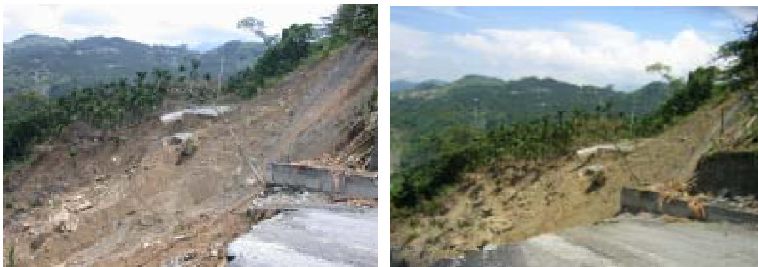
圖 5.43 台 18 線五彎仔路斷崩塌實景
