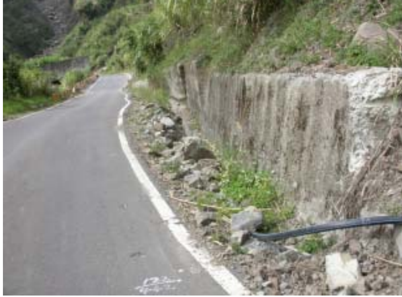
圖 7.58 牆面龜裂嚴重並有位移的情形（台 21 線 126k+700 757）
