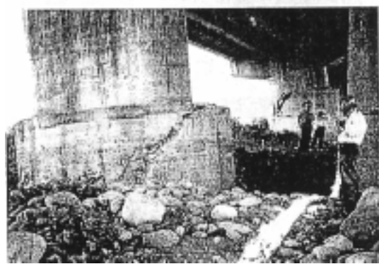
(b)烏溪橋沉箱剪力破壞
