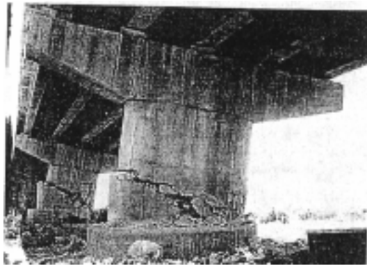
(a)烏溪橋橋柱剪力破壞
