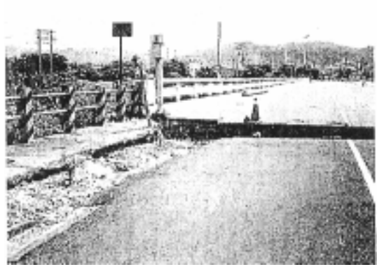
(b)大峰橋橋台、引道高低差
