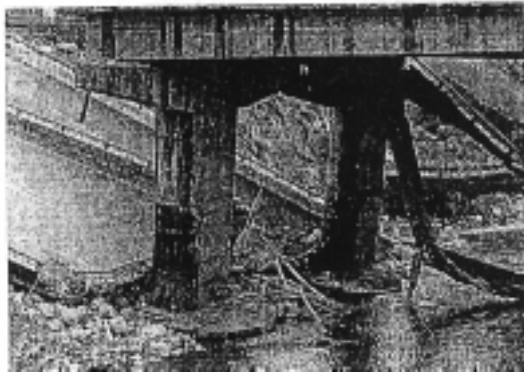
(a)石圍橋基礎傾斜導致落橋
