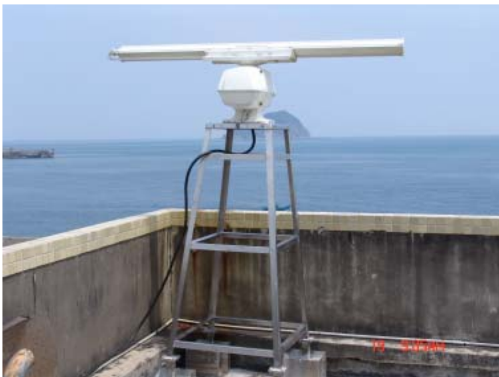
照片 21 海洋工程館頂樓之雷達天線
