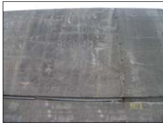
照片 4.12 花蓮港新東堤堤身地圖狀裂縫2
