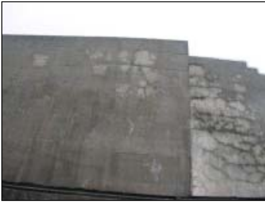
照片 4.11 花蓮港新東堤堤身地圖狀裂縫1
