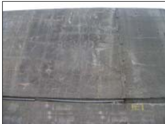
照片 4.3 花蓮港新東堤堤身地圖狀裂縫 2
