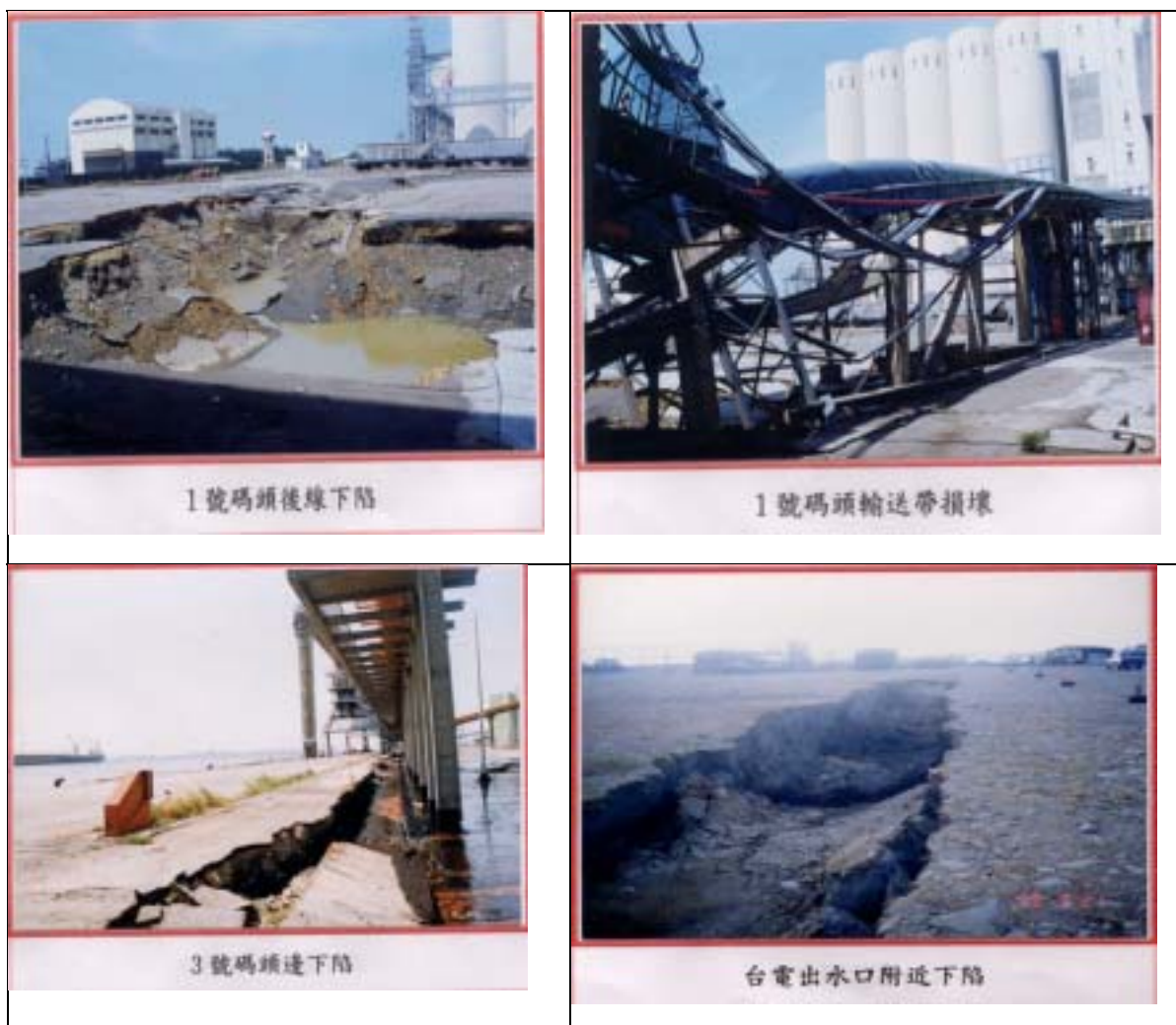
圖 3-4-1 九二一地震臺中港受損狀況照片
