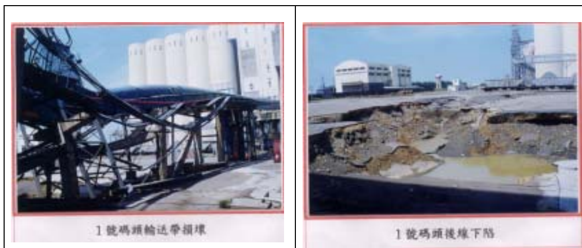
圖 3-2-8 臺中港區九二一地震災害照片
