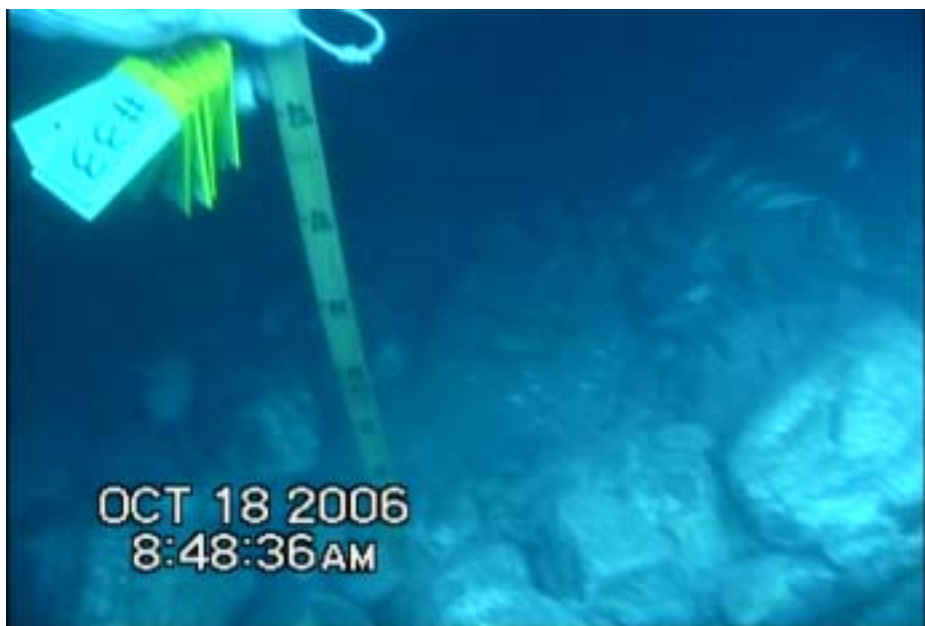
照片 5.3 花蓮港東防波堤 # 34 沉箱底部掏空範圍擴大至 # 33 沉箱
