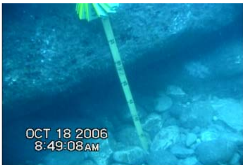
照片 5.2 花蓮港東防波堤 # 34 沉箱底部掏空範圍
