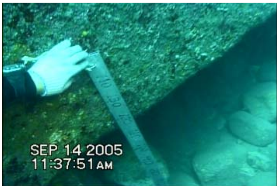
圖 5.1 94 年花蓮港東防波堤#65 沉箱外海側底部掏空情形
