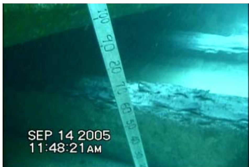
圖 5.2 94 年花蓮港東防波堤#71 沉箱外海側底部掏空情形
