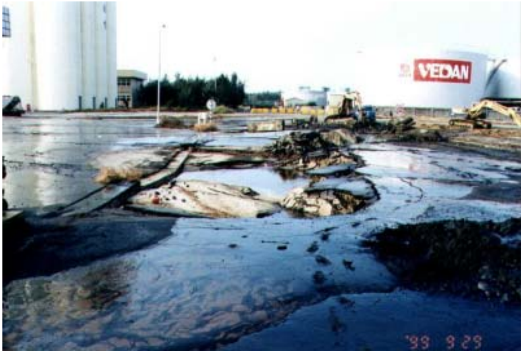
圖 3.7 921 臺中港糖蜜儲槽災損情形
