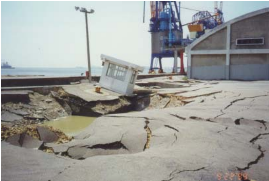
圖 3.3 #1~#4 沉箱式碼頭後線災損情形
