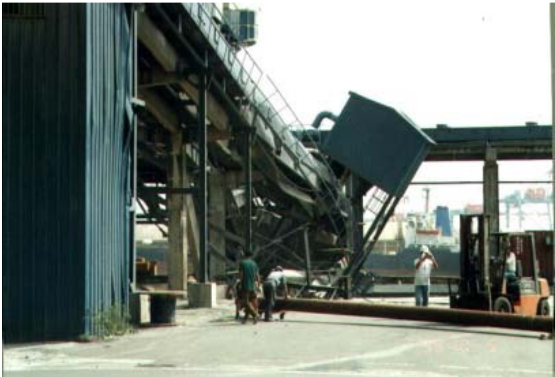
圖 3.4 921 臺中港裝卸設施災損情形
