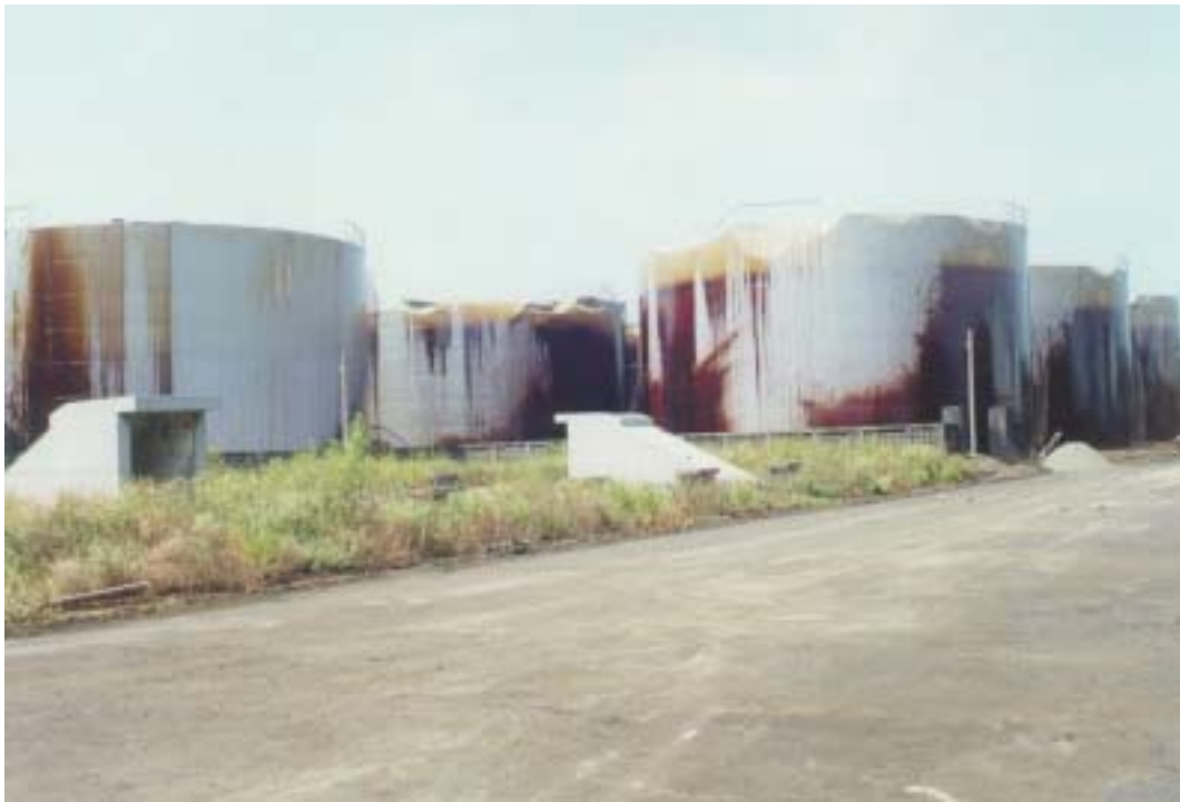
圖 3.6 921 臺中港儲槽災損情形
