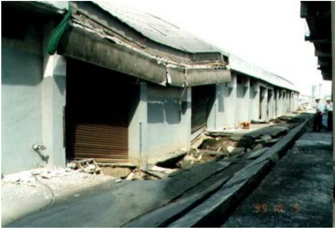
圖 3.5 921 臺中港倉儲設施災損情形
