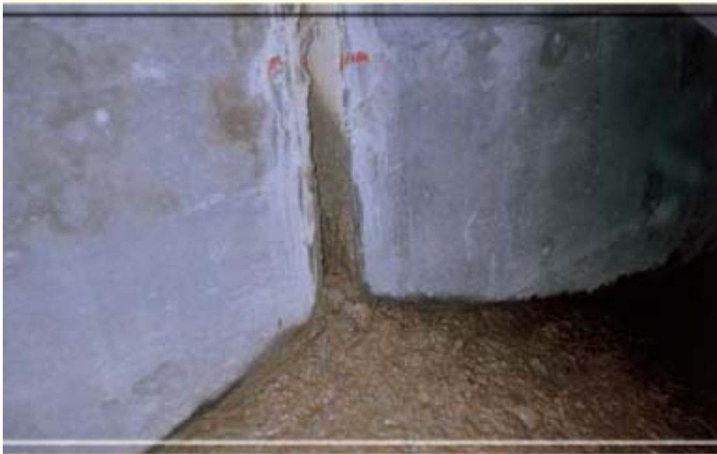
路堤下方排水箱涵伸縮縫開裂情況
