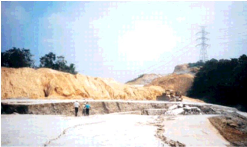
圖 10-22 路堤邊坡現場坍滑照片
