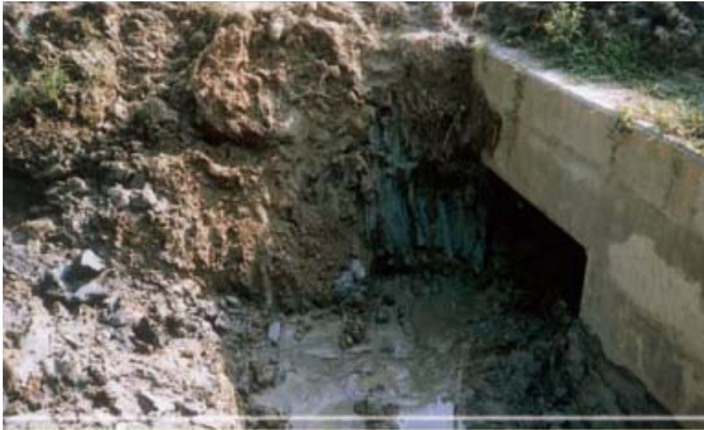
排水箱涵入口處受坍滑影響被掩埋情況
