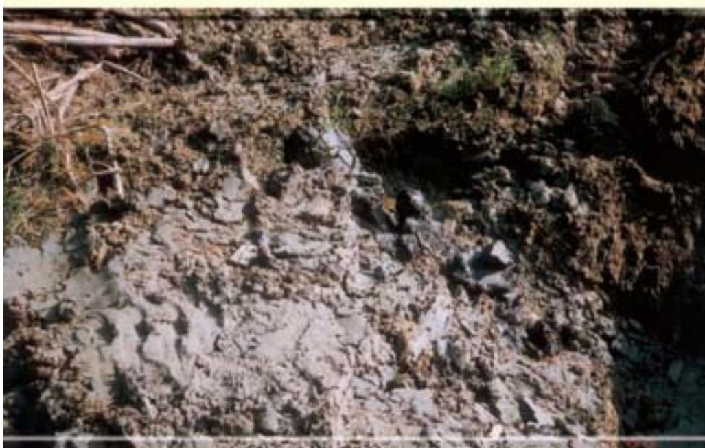
坍塌坡趾處被擠出之沉泥情況
