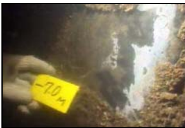
圖 2.10 海生物敲除後之鋼板樁表面 (2)
