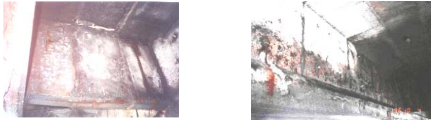
圖 2-2 腐蝕、龜裂與破裂之連續循環現象例
