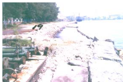
圖 2-5 龜裂、破裂、沉陷、傾斜與拱起之連續循環結果例
