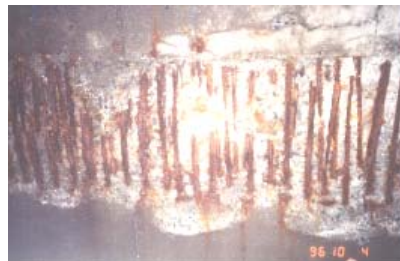
圖 2-3 腐蝕、龜裂與破裂連續循環之結果例
