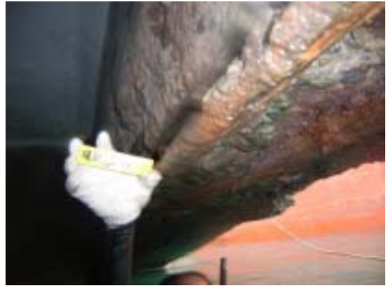
(2) 底樑鋼筋腐蝕生銹、混凝土剝落 1
