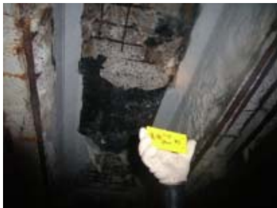
(3) 面版鋼筋腐蝕生銹、混凝土剝落 2
