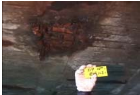
(6) 面版混凝土滲水處鋼筋腐蝕外露
