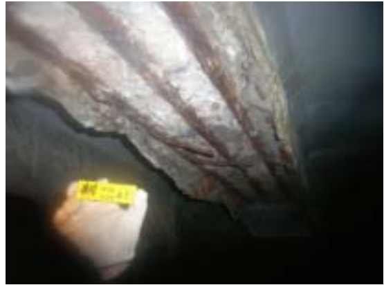
(4) 底樑鋼筋腐蝕生銹、混凝土剝落 3
