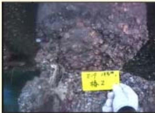
碼頭R.C.樁破壞現況
