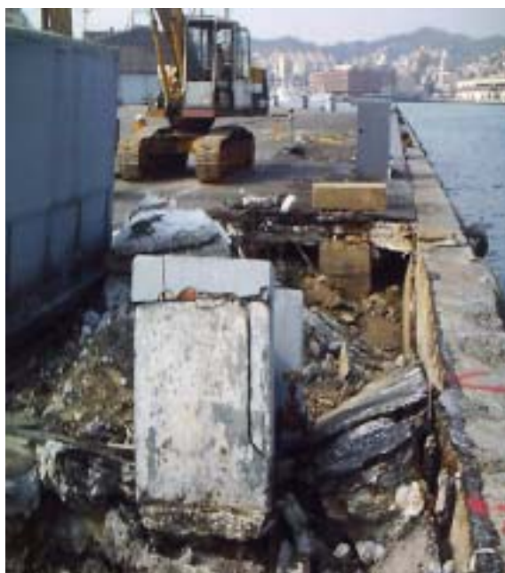
圖4.26 基隆港東5碼頭岸壁崩塌傾斜情形
