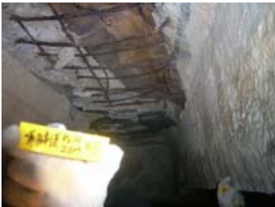
(5) 面版鋼筋腐蝕生銹、混凝土剝落 2
