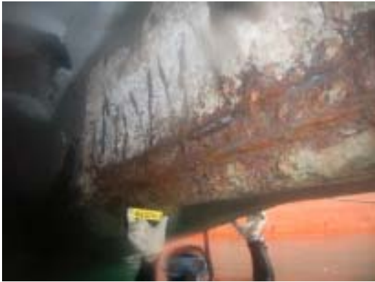
(3) 底樑鋼筋腐蝕生銹、混凝土剝落 2
