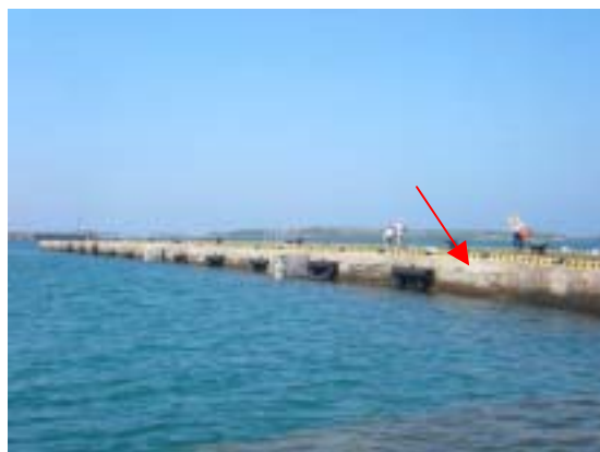
(6) 4 號碼頭岸壁混凝土破損情形
