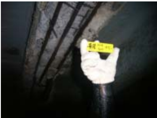
(3) 底樑鋼筋腐蝕生銹、混凝土剝落 2
