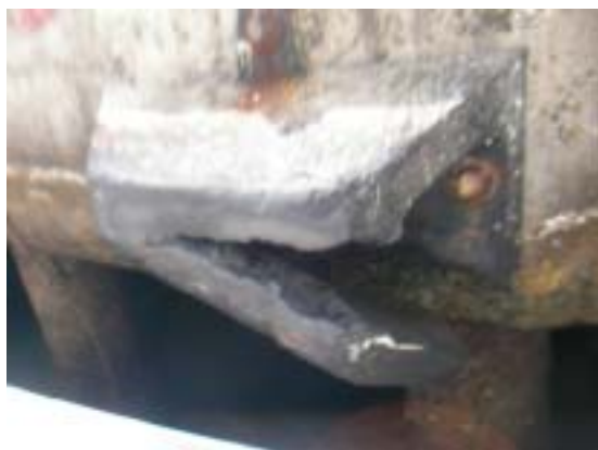
(5) 1 號碼頭第 7 單元護舷碰墊破損
