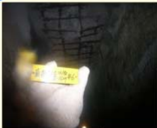
碼頭R.C.底版破壞現況
