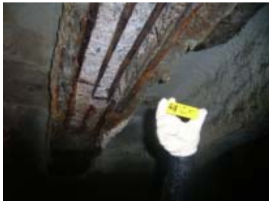
(4) 底樑鋼筋腐蝕生銹、混凝土剝落 3
