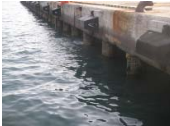
(2) 1 號碼頭第 1 單元基樁混凝土剝落
