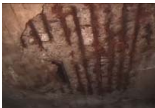
(6) 面版與樁頭交接處鋼筋外露 4
