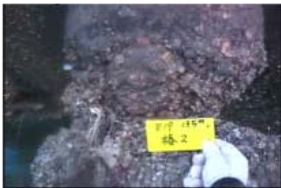
(1) 13.5m 處基樁混凝土劣化情形
