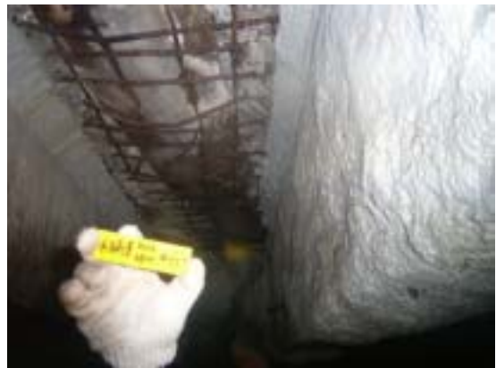
(6) 面版鋼筋腐蝕生銹、混凝土剝落 3
