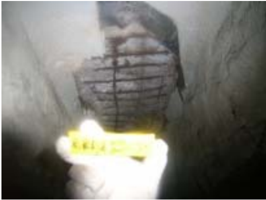
(1) 面版鋼筋腐蝕生銹、混凝土剝落 1
