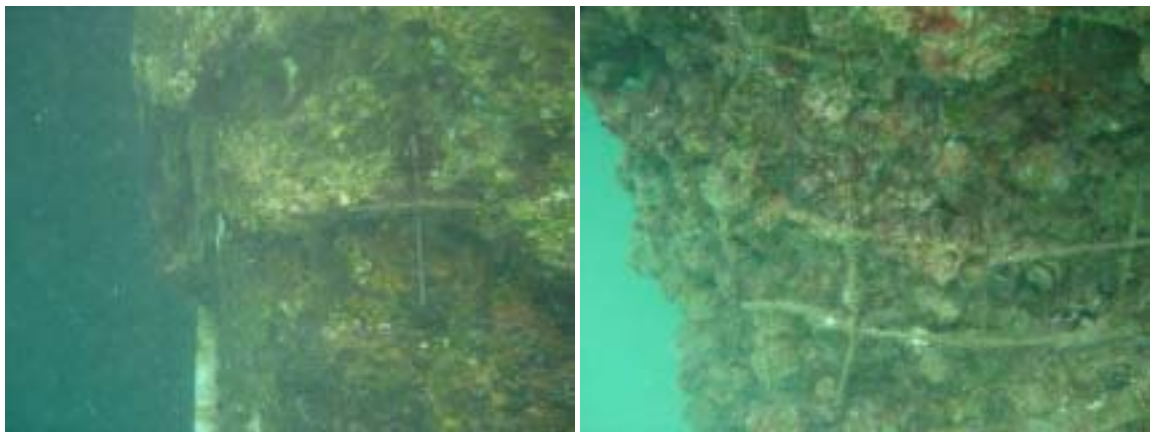
(1) 基樁混凝土脫落、鋼筋外露情形1 (2) 基樁混凝土脫落、鋼筋外露情形2
