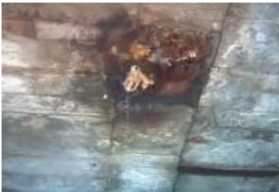
(5) 面版混凝土滲水情形
