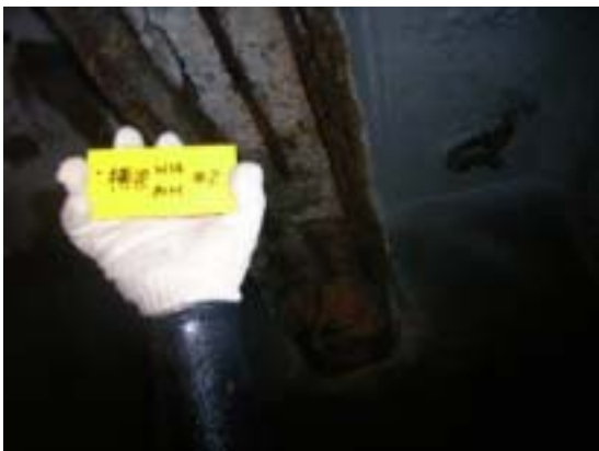
(3) 底樑鋼筋腐蝕生銹、混凝土剝落 4
