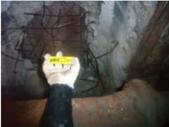
(1) 面版鋼筋腐蝕生銹、混凝土剝落 1
