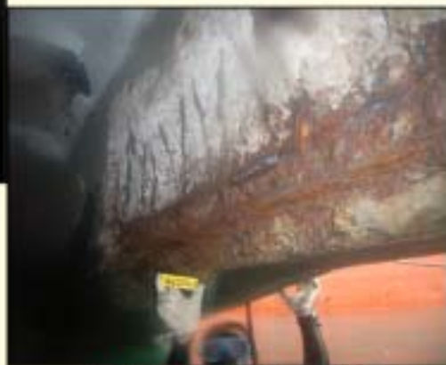
碼頭R.C.梁破壞現況
