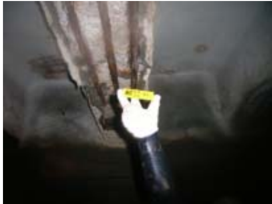
(2) 底樑鋼筋腐蝕生銹、混凝土剝落 1
