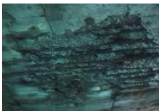
(4) 面版與樁頭交接處鋼筋外露 2
