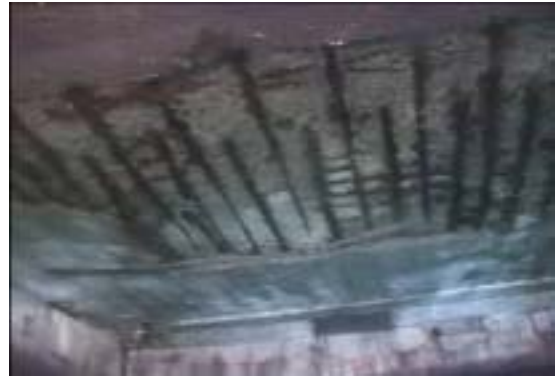
(4) 面版與樁頭交接處鋼筋外露 4
