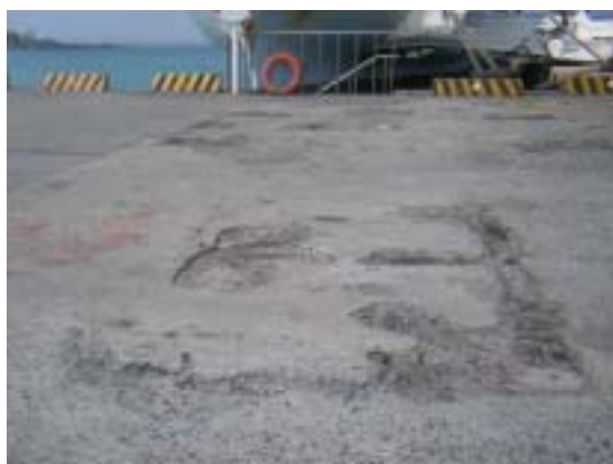
(3) 1 號碼頭第 1 單元路面劣化情形
