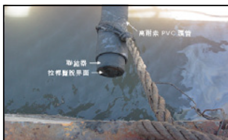
照片 3-2 第 82 號上層拉桿斷脫照片(一)
