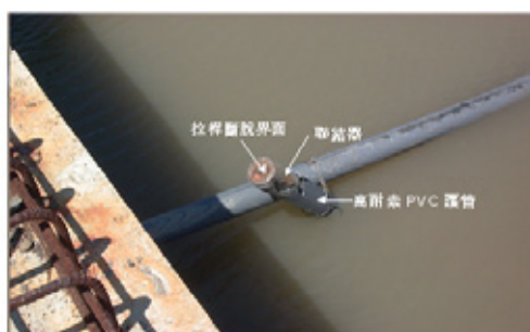
照片 3-3 第 88 號下層拉桿斷脫照片(二)
