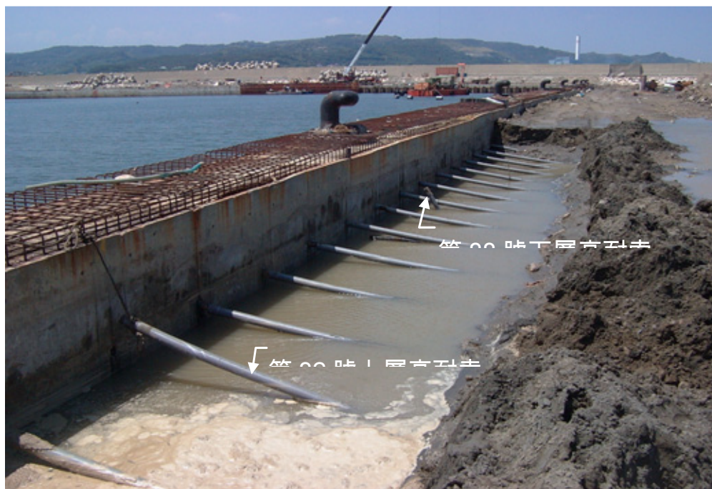
照片 4-2 施工時第 81~88 號下層高耐索斷落，碼頭側移 70 多公分
