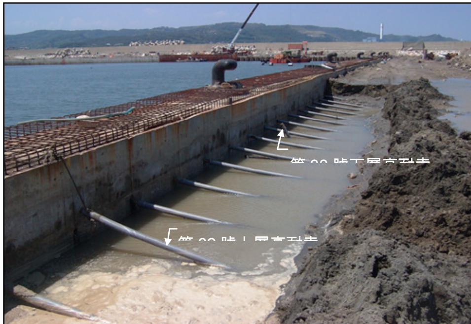
圖 施工時第81~88號下層高耐索斷落，碼頭側移70多公分
