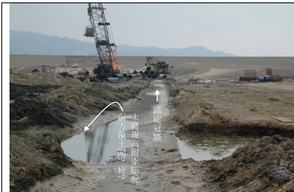
照片 錨碇冠牆向海側傾斜位移
