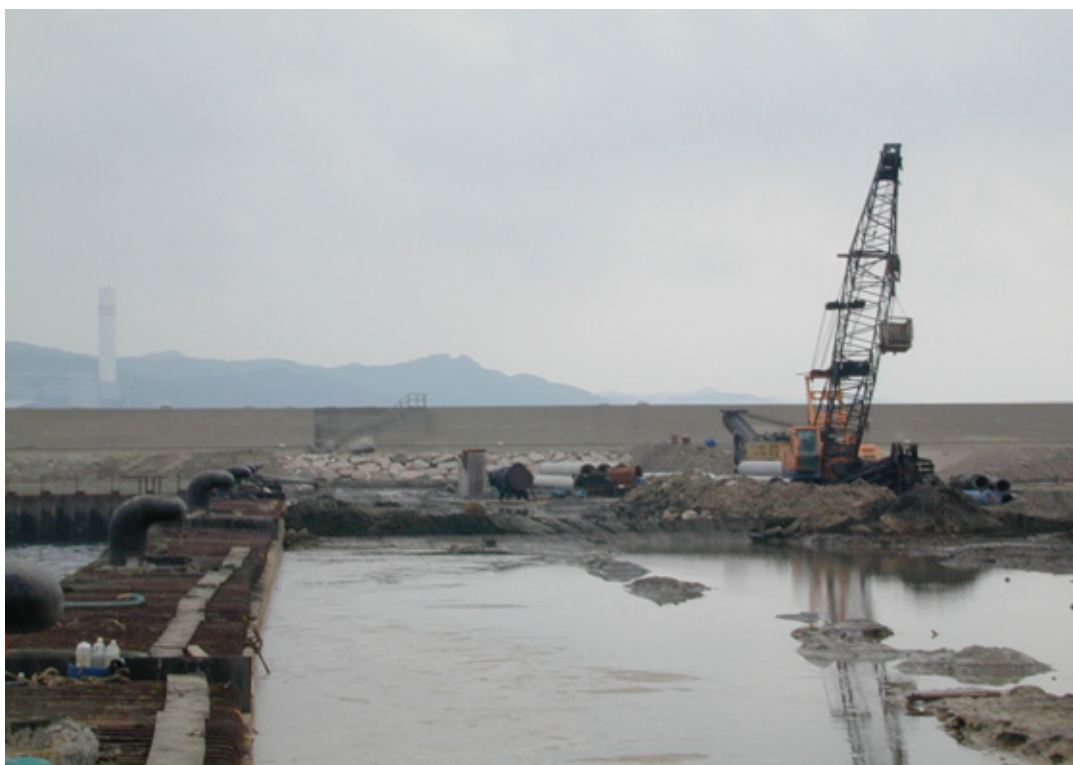
照片 4-4 E14 碼頭法線冠牆中段凸出(向 E13 縮弧)
