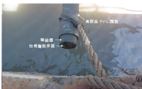
照片 3-2 第 82 號上層拉桿斷脫照片(一)
