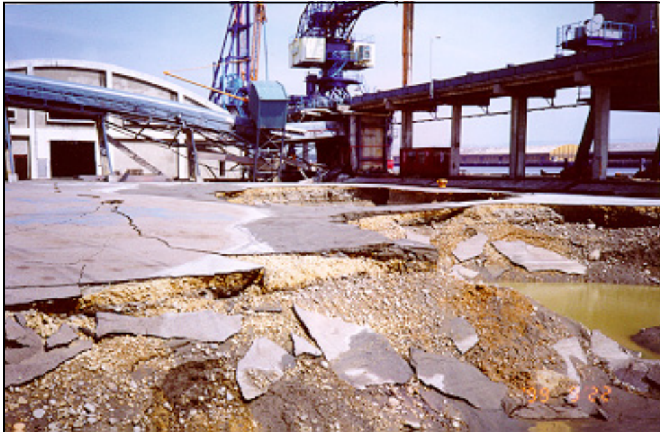
照片 台中港1號碼頭後線背填土之砂液化流失，造成約4-5m深之大坑洞，地表並留下約10cm厚之噴砂
