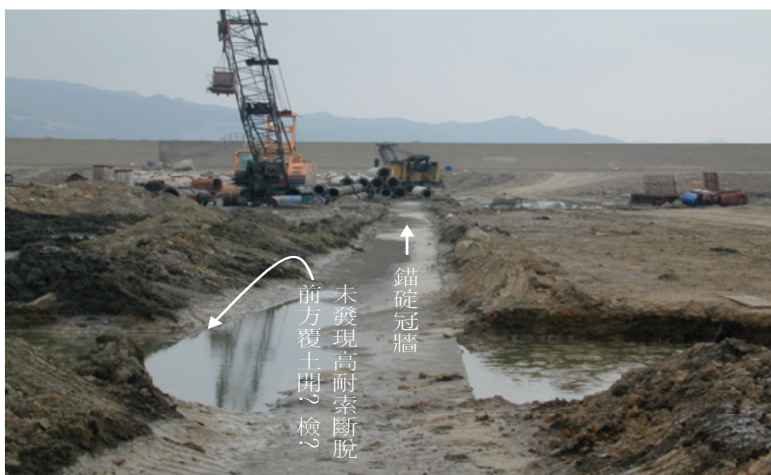
照片 4-5 錨碇冠牆向海側傾斜位移
