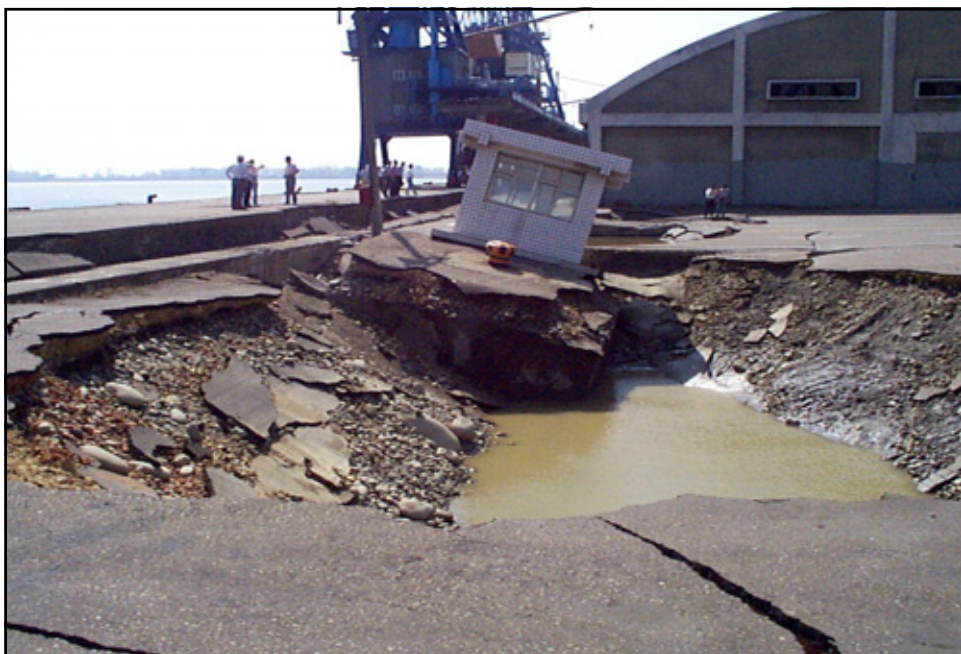
照片 台中港2號碼頭後線之大坑洞
