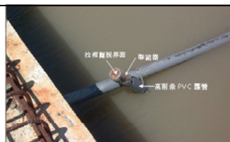
照片 3-3 第 88 號下層拉桿斷脫照片(二)
