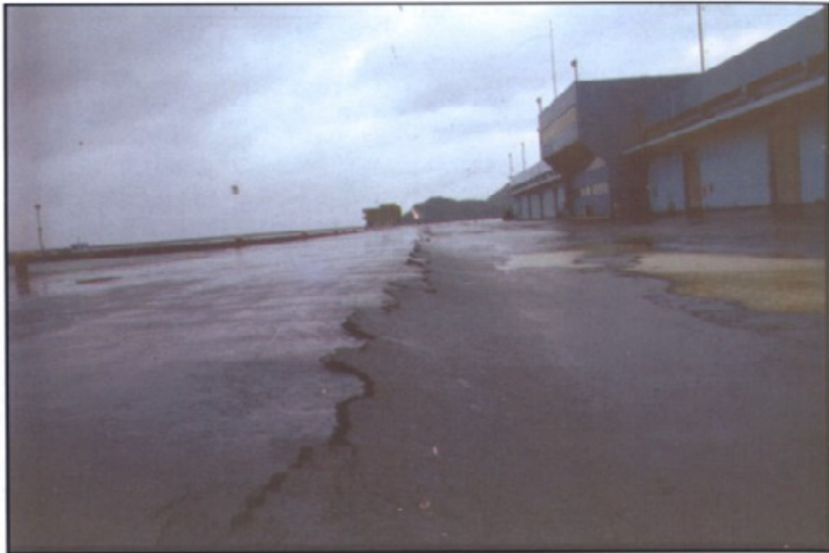
照片 民國75年地震造成蘇澳港4-5號碼頭後線下陷龜裂500公尺
