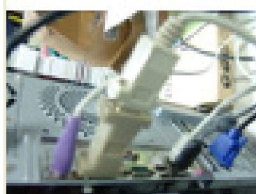
PLC 外部與主控台裝設位置
