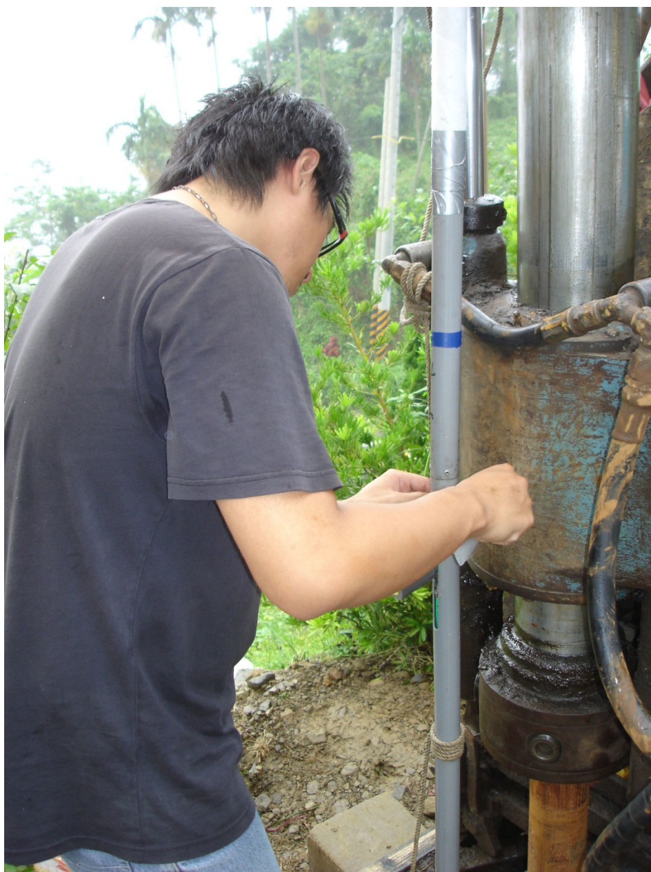
圖 4.6 NCTU-02 光纖光柵水壓計裝設概況圖
