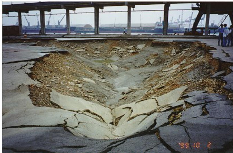
圖1.1.2 臺中港1至4A碼頭內災損情況
