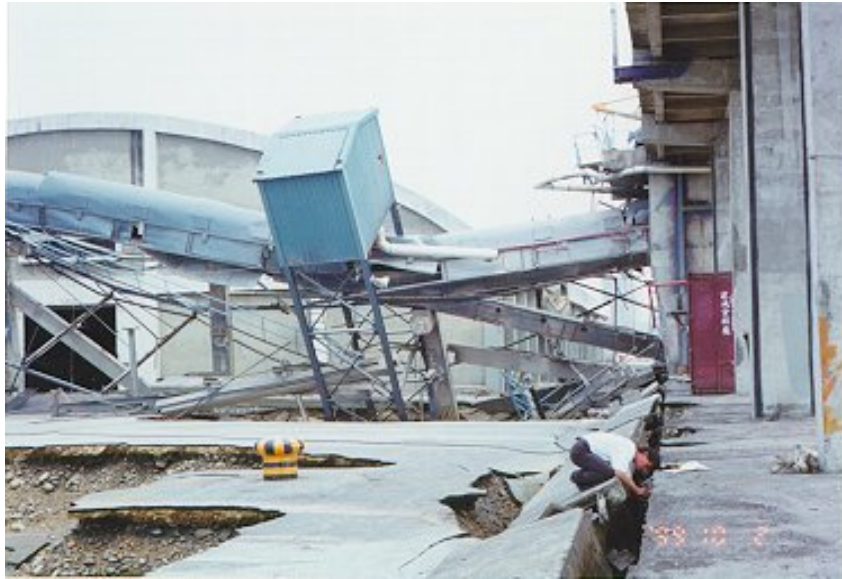
圖1.1.3 臺中港倉儲輸送設備災損情況
