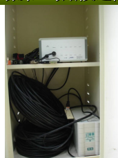
儀器設備箱內部設備狀況
