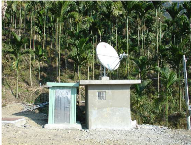
圖 3-40 臺 18 線 45K 自動化監測儀器小屋
