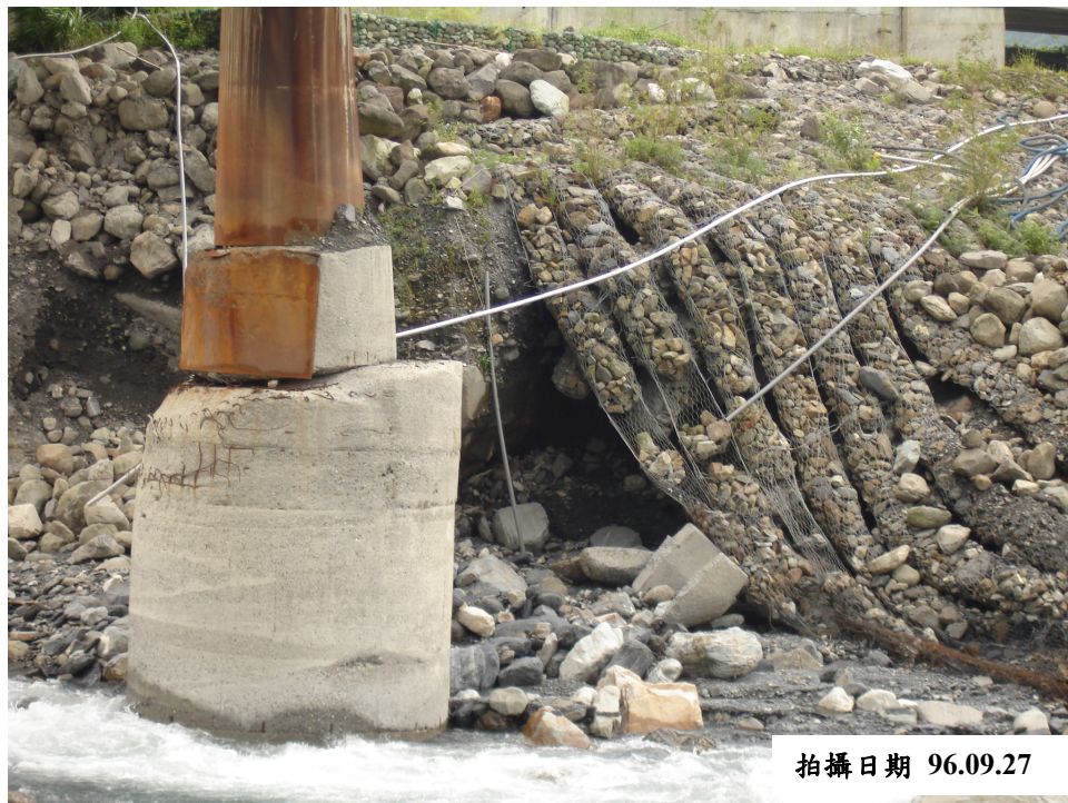
圖 4-59 石籠堤防受土石、洪水流破壞
