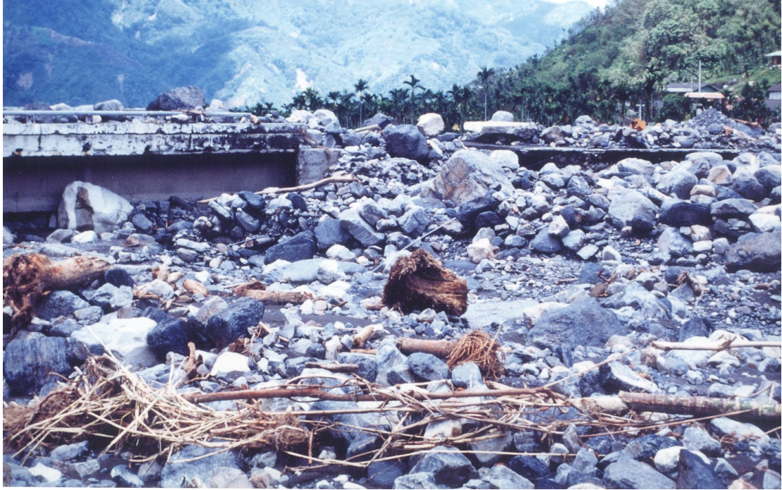
圖 4-3 賀伯颱風期間信義橋 A1 橋台附近大量土石淤積災況
