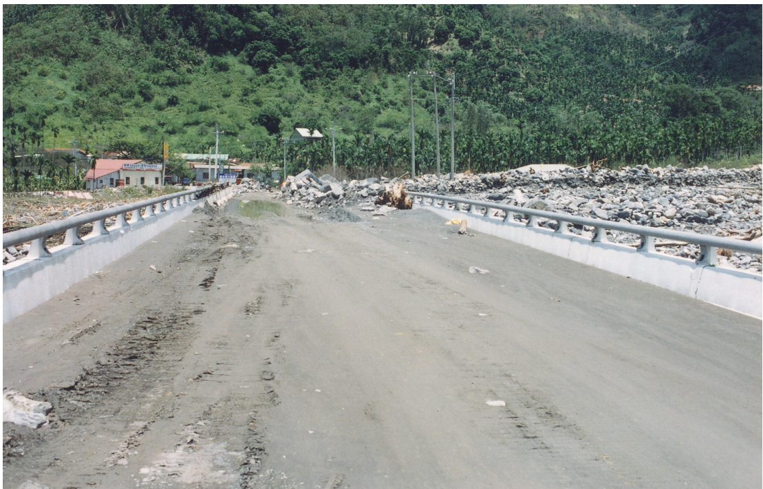
圖 4-4 賀伯颱風期間信義橋橋面遭土石淤埋情形
