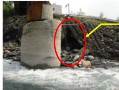
石籠堤防破壞
