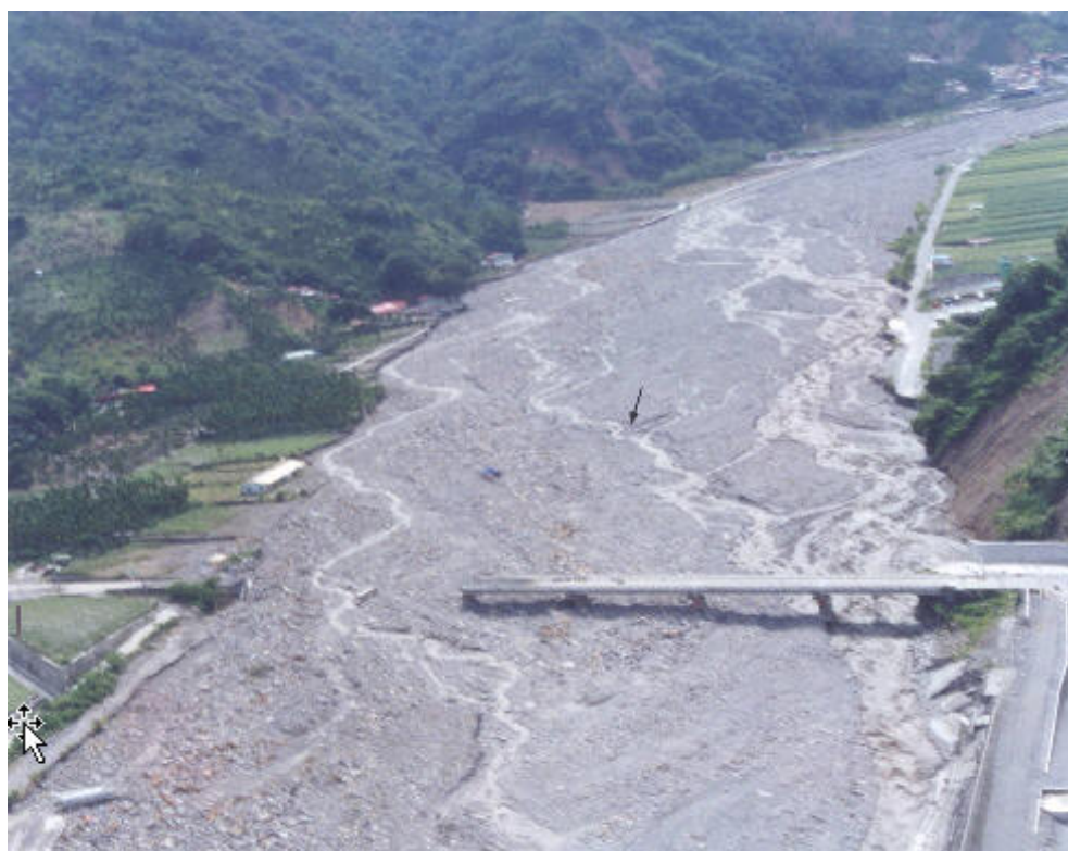
圖 4-6 桃芝颱風期間，信義橋第一、二跨橋面流失情形
