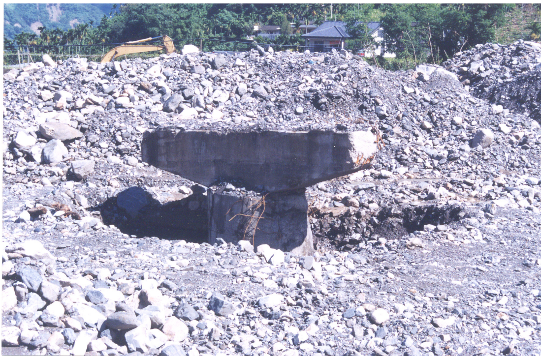
圖 4-7 桃芝颱風後 P1 橋墩墩柱營水面遭土石流撞擊造成鋼筋外露
