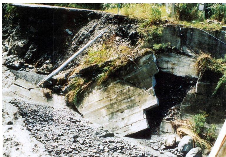
圖 4-39 賀伯颱風期間，十八重溪橋南端橋台上游護岸破壞情形
