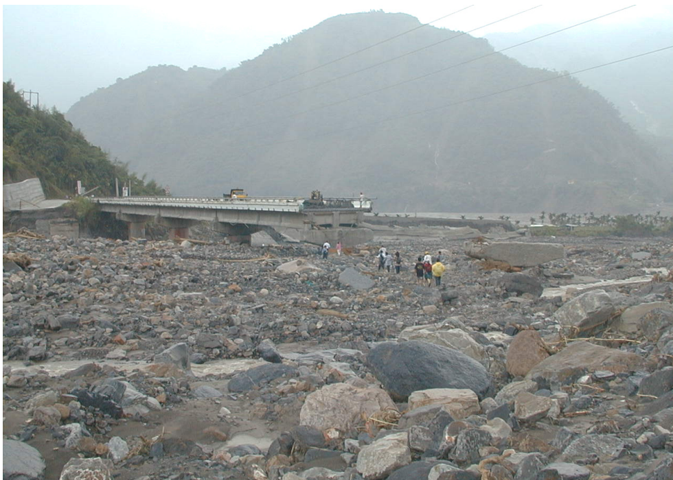
圖 4-5 土石淤積造成信義橋樑淨空不足，橋面抬升流失
