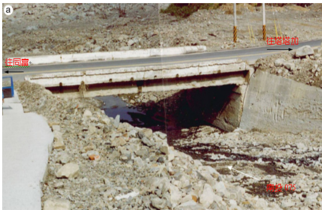
圖 4-66 桃芝風災後愛玉橋橋體及橋台翼牆遭土石流磨蝕的情形
