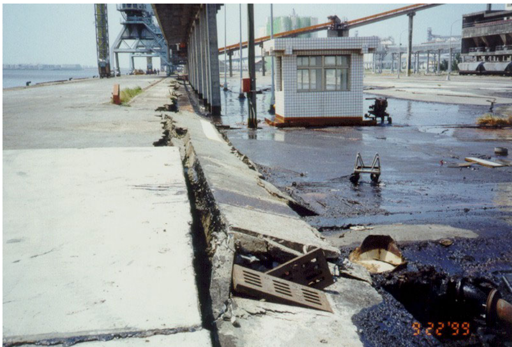
圖 3.2 #1~#4 沉箱式碼頭岸肩與後線高程差側視圖
