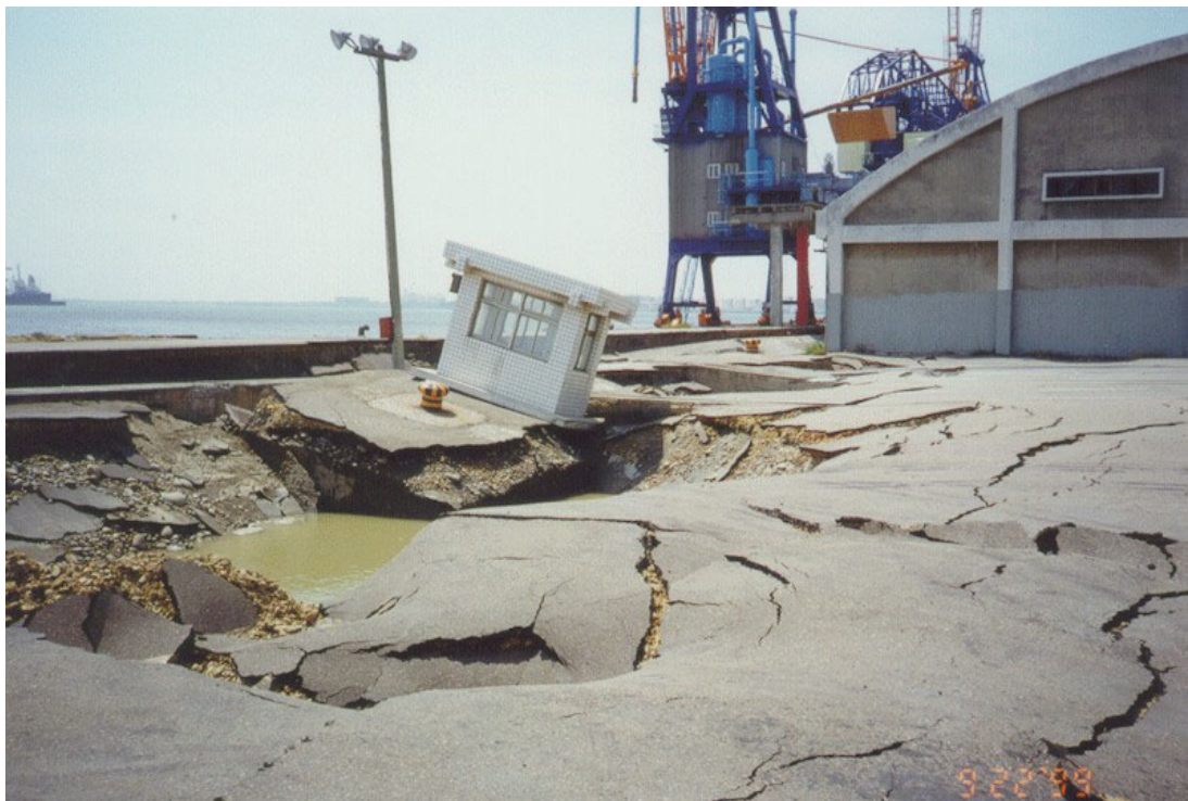
圖 3.3 #1~#4 沉箱式碼頭後線災損情形
