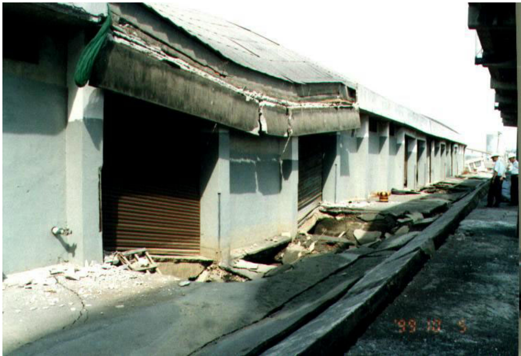
圖 3.5 921 臺中港倉儲設施災損情形
