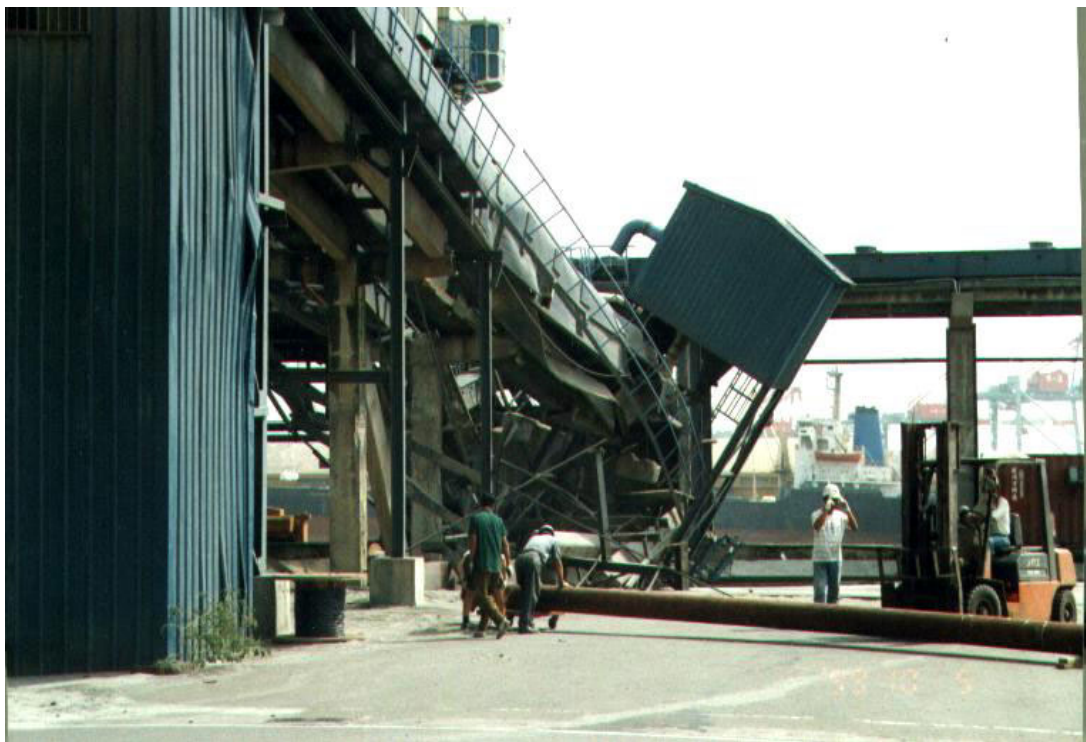
圖 3.4 921 臺中港裝卸設施災損情形
