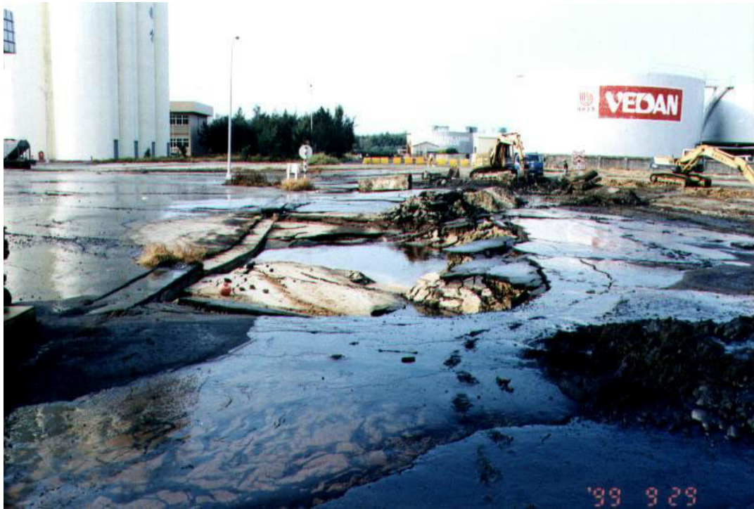
圖 3.7 921 臺中港糖蜜儲槽災損情形
