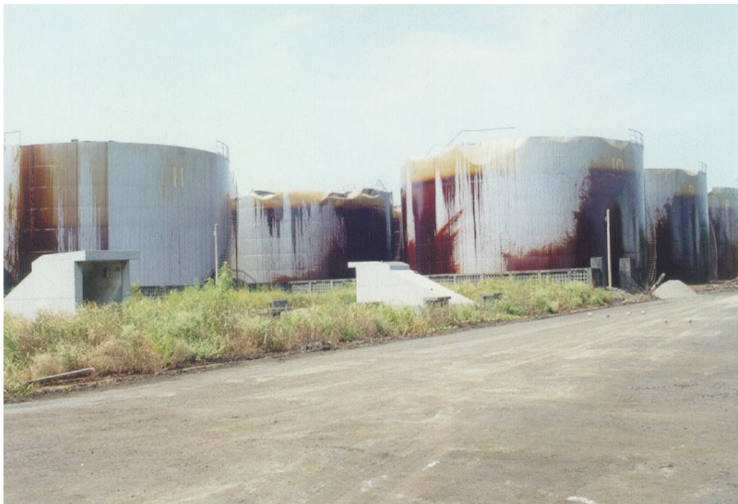
圖 3.6 921 臺中港儲槽災損情形
