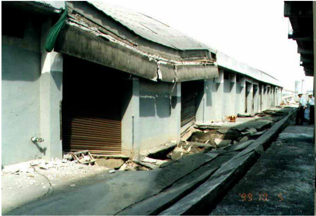
圖 3.5 921 臺中港倉儲設施災損情形
