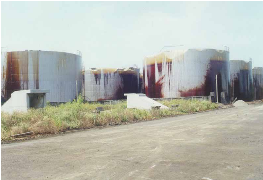
圖 3.6 921 臺中港儲槽災損情形
