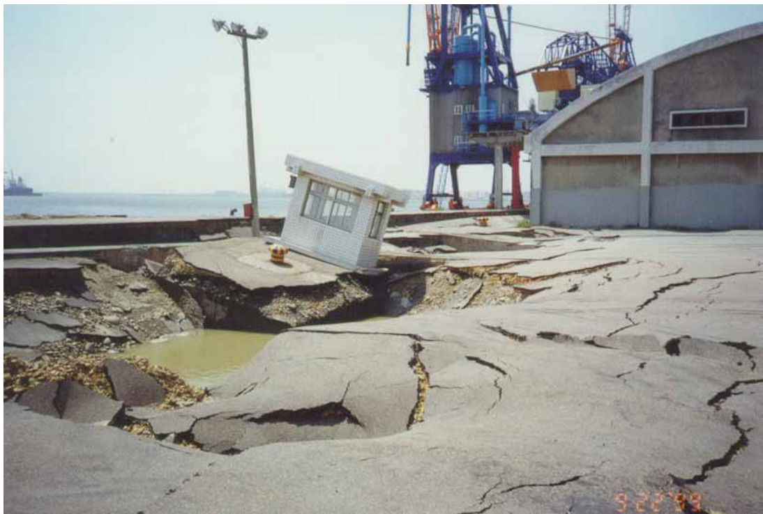
圖 3.3 #1~#4 沉箱式碼頭後線災損情形
