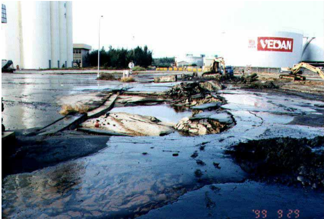
圖 3.7 921 臺中港糖蜜儲槽災損情形
