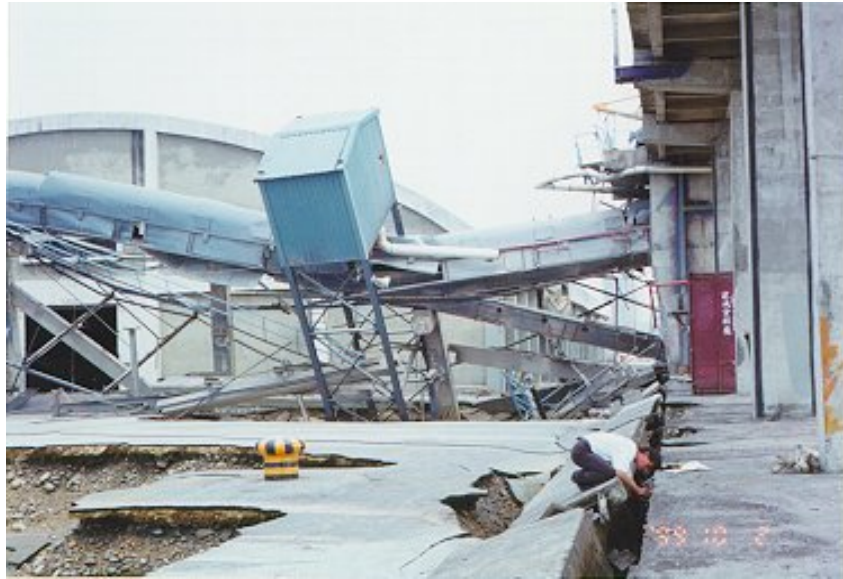
圖1.1.3 臺中港倉儲輸送設備災損情況
